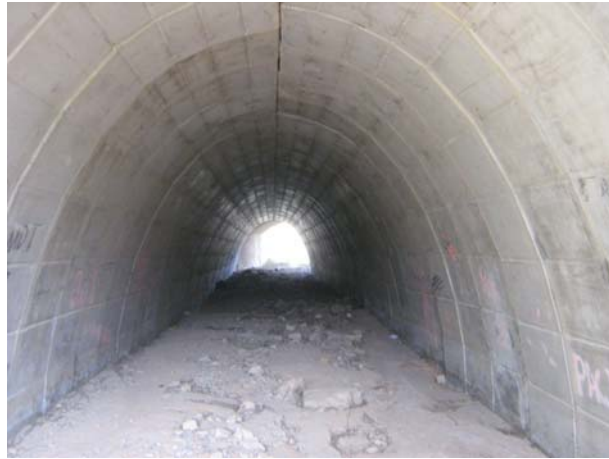
15 - Interior de l'obra de drenatge de la carretera C-12 al barranc de la Peixera.
