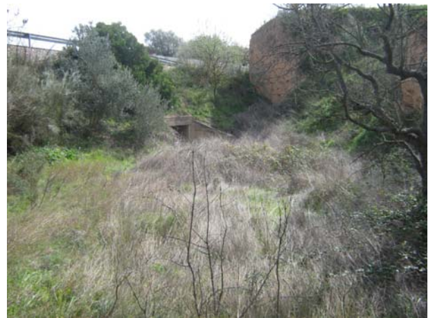
24 - Entrada de l'obra de drenatge de la carretera C-12 al barranc de Los Aubals.
