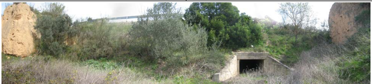
27 - Vista des d'aigua amunt de l'obra de drenatge de la carretera C-12 al barranc de Los Aubals. La llera queda encaixada en aquest punt.
