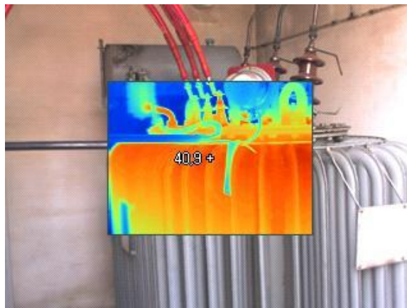
Fig. 11 Imagen termográfica tráfo MT en la ETAP
