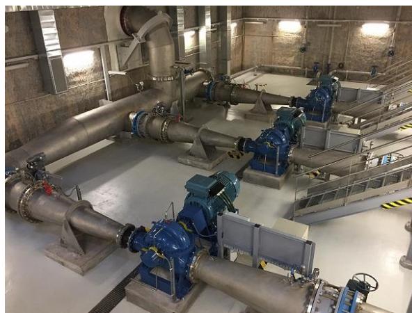
Fig. 6 Foto de la central de impulsión cota 70
