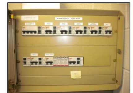
Figura 5.1.d. LEMS Aire acondicionat.
