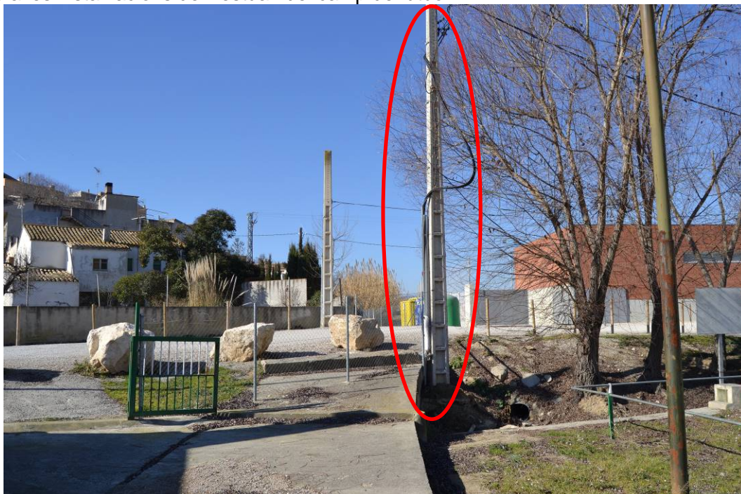
Fotografia 1. Serveis elèctric afectats
