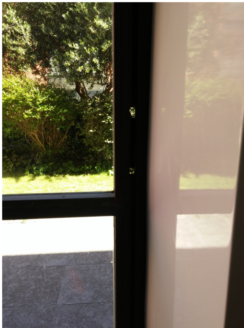
Ilustración 17: Defectos juntas carpintería
