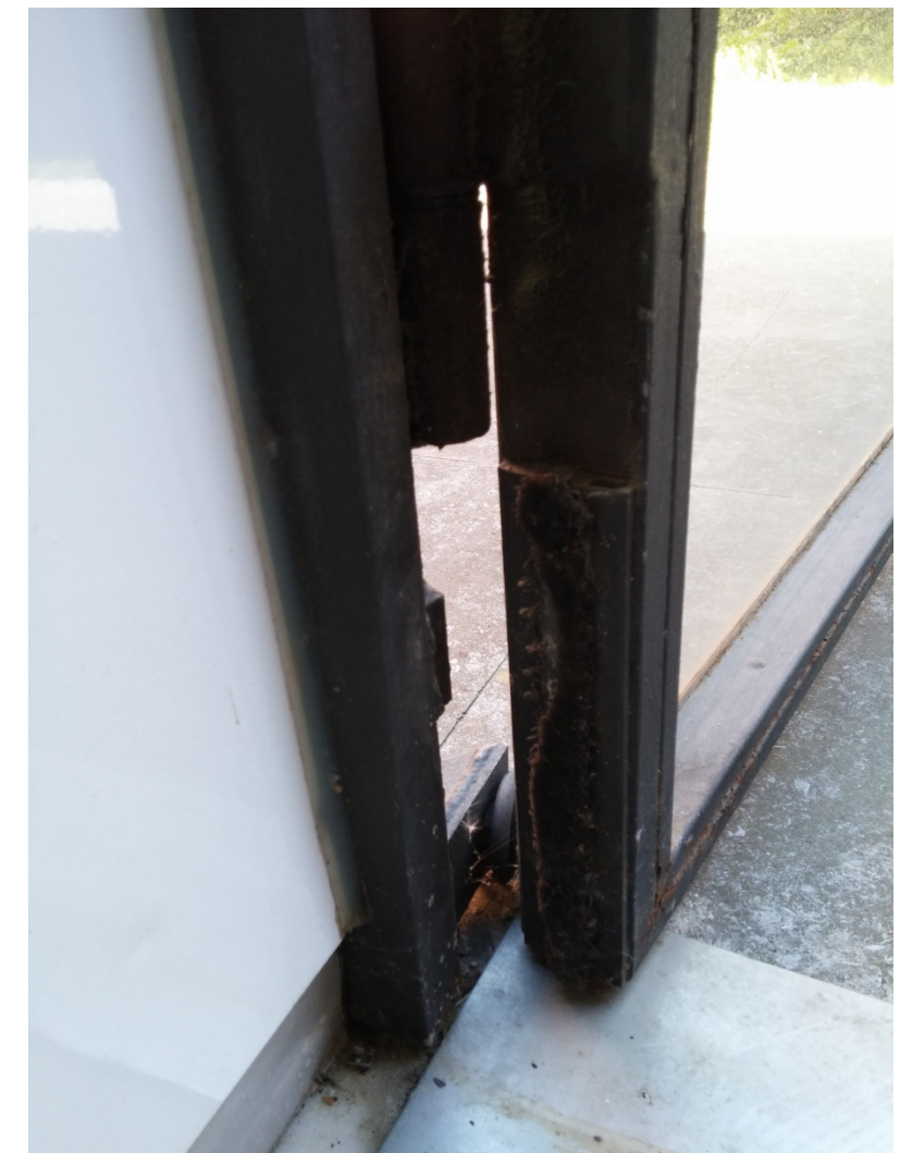
Ilustración 15: Defectos juntas carpintería
