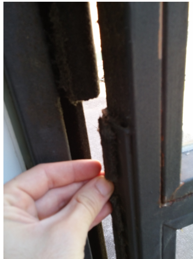
Ilustración 16: Defectos juntas carpintería
