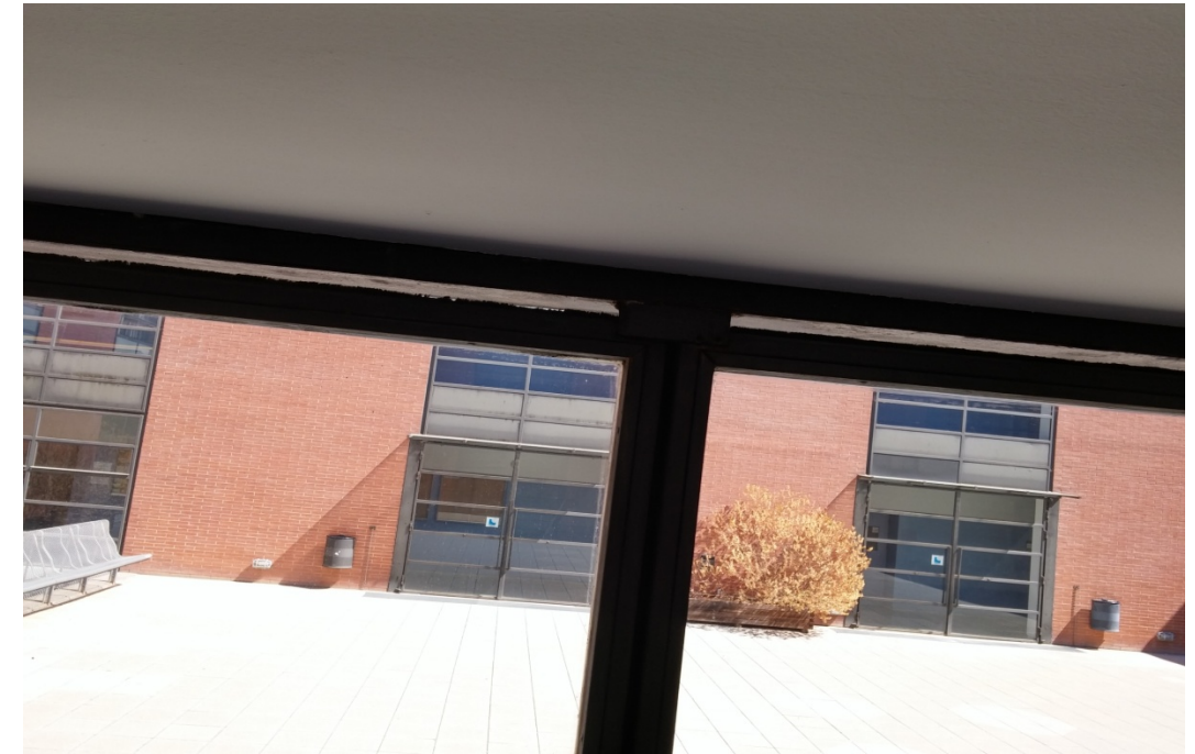
Ilustración 14: Defectos juntas carpintería
