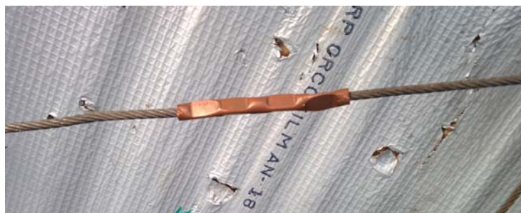
Fig. 3.4 Unión de cobre entre dos cables de mando
