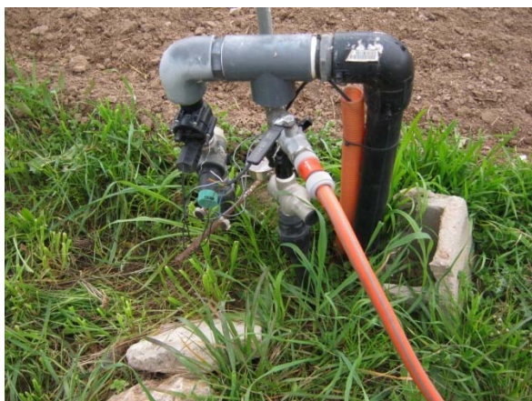
Imatge 7 Detall de la manega connectada al punt d'aigua
