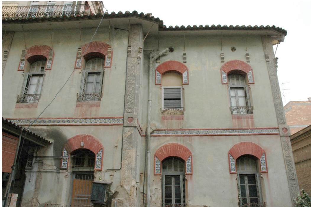
Imatge prèvia a la restauració, en la que s'evidencia l'estat de deixadesa de l'edifici.
