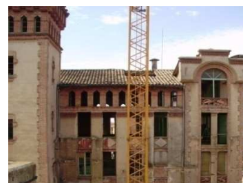
Figura 4.3 Reforma recent de l'edifici en mal estat (coberta i finestres)
