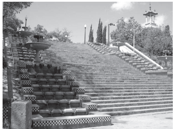
Fig. 2.20 Passeig de les Cascades de Rubió i Tudurí i Forestier a Barcelona: a) part superior pendent de rehabilitació, b) part inferior rehabilitada (fotografies de l'autor)
