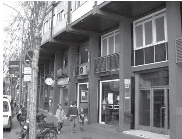
Fig. 6.35 Unitats exteriors apantallades, descobertes i amb filtre acústic. Via Augusta, Barcelona (fotografia de l'autor)
