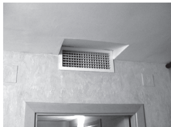
Fig. 7.54 Reixa de l'aire condicionat amb nínxol en afegir-hi un fals sostre (fotografia de l'autor)
