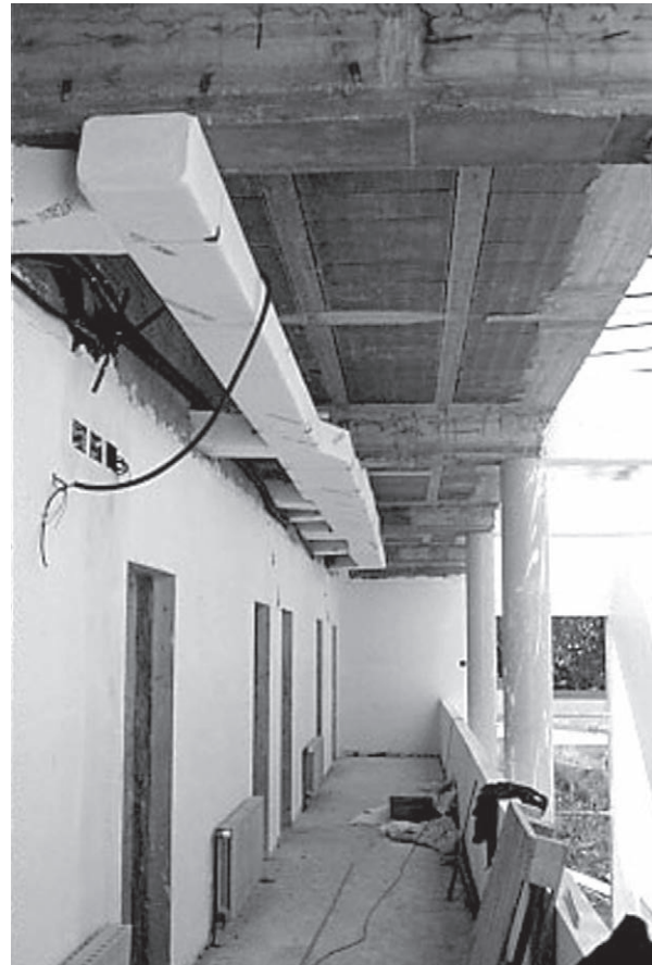
Fig. 1.36 Instal·lació de l'aire condicionat al Centre Cívic de Navarcles (fotografia de l'autor)
