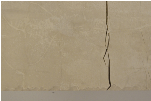
e. Grietas por deformación.
