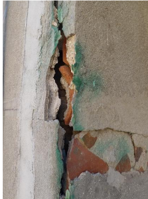
Imatge 8.1-5: morter de ciment trencat. Font: pròpia.
