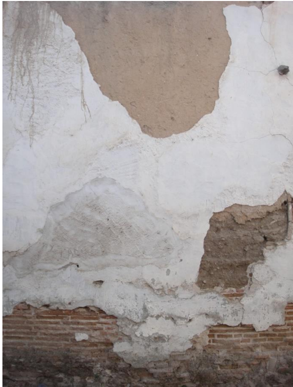
Imatge 8.1-4: com trenca el revestiment de calç. Font: pròpia.
