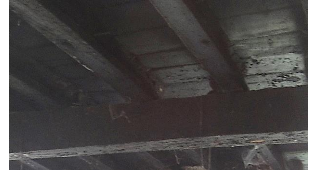
Imatge 4.3-1: Estructura d'un sostre de fusta d'una casa en ruïnes. Font: pròpia.
