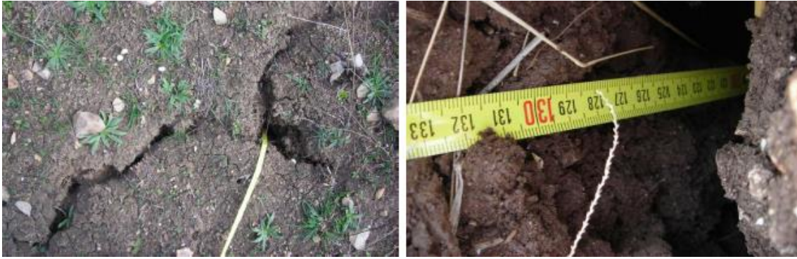
Figura 6: Grietas de desecación desarrolladas en el suelo arcilloso aflorante en la ladera de Pisciole durante el mes de Agosto de 2012. A la izquierda se puede observar el patrón típico de fracturación desarrollado, a la derecha se muestra la máxima profundidad medida en las grietas de desecación identificadas. [G. Pedone, 2014]
