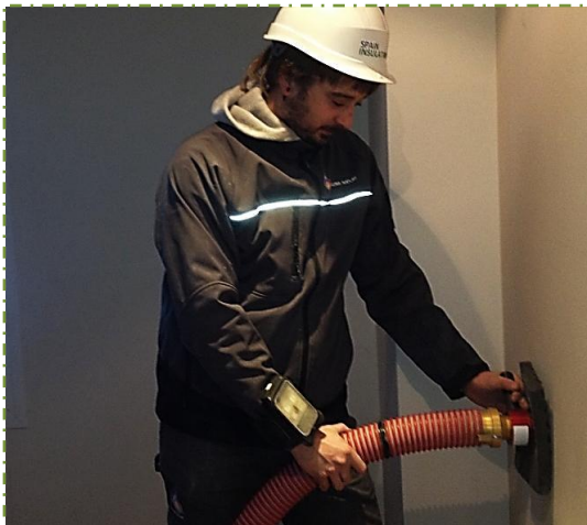
Ilustración 19 Muestra de instalación de celulosa insuflada por método de manguera. Fuente: Spain insulation
