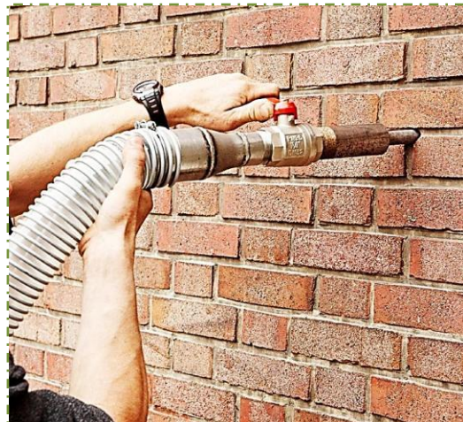
Ilustración 20 Muestra de la aplicación de celulosa insuflada por método de boquilla Fuente: Presupueston.com
