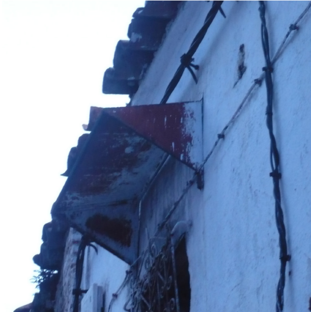
Imatge 51. Chapa metálica.
