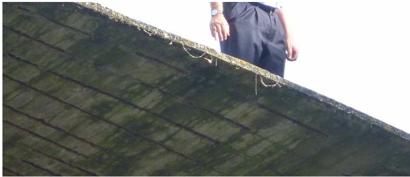
Fotografía 1: Fisuras de la lámina
