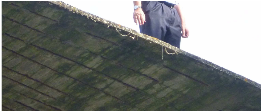
Fotografía 5: Fisuras de la lámina
