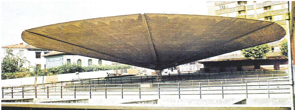
Figura 1: Paraguas antes de su primera reforma
