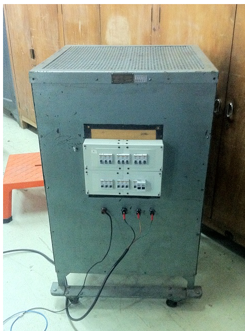
Figura I.9: Armari de resistències utilitzat com a càrrega
