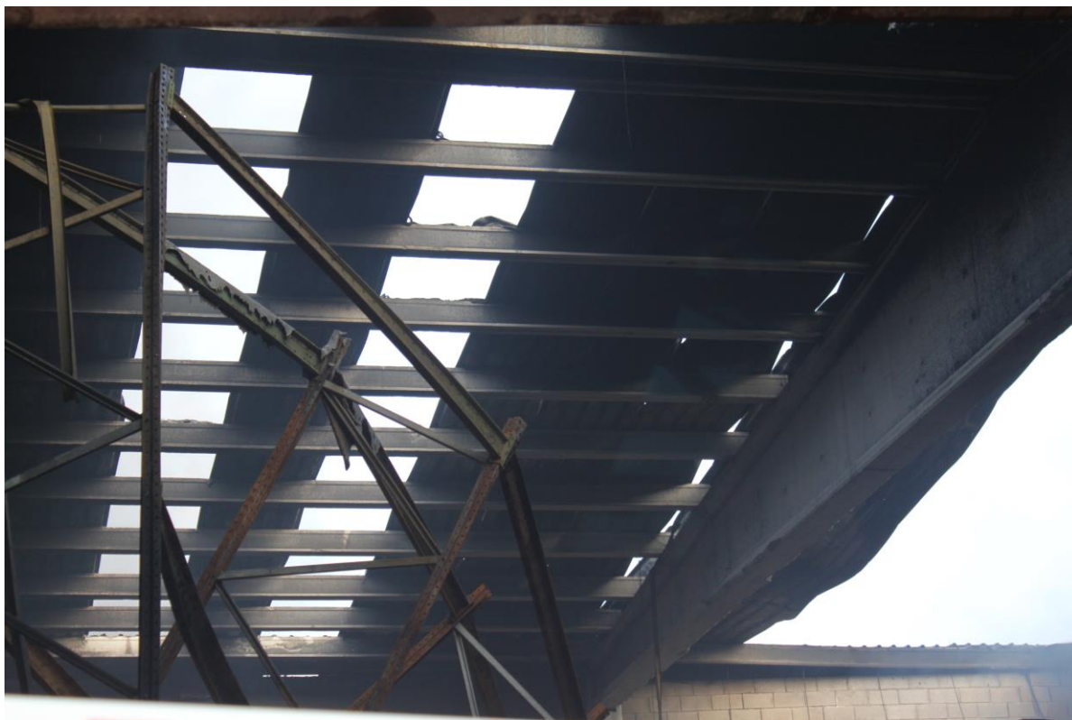
Fotografia 5: Danys en corretges de formigó prefabricat
