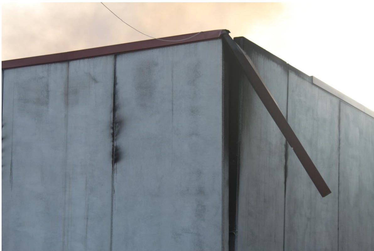
Fotografia 3: Danys en estructura de formigó
