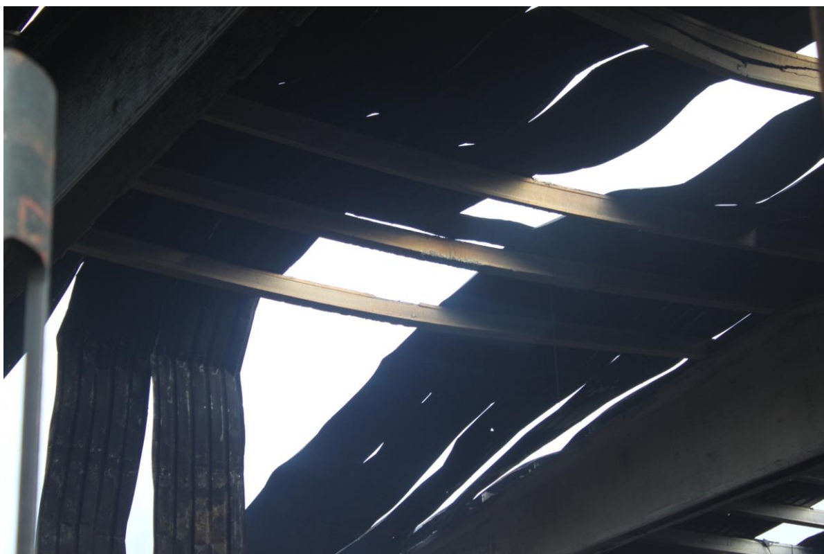
Fotografia 4: Danys en estructura principal de coberta
