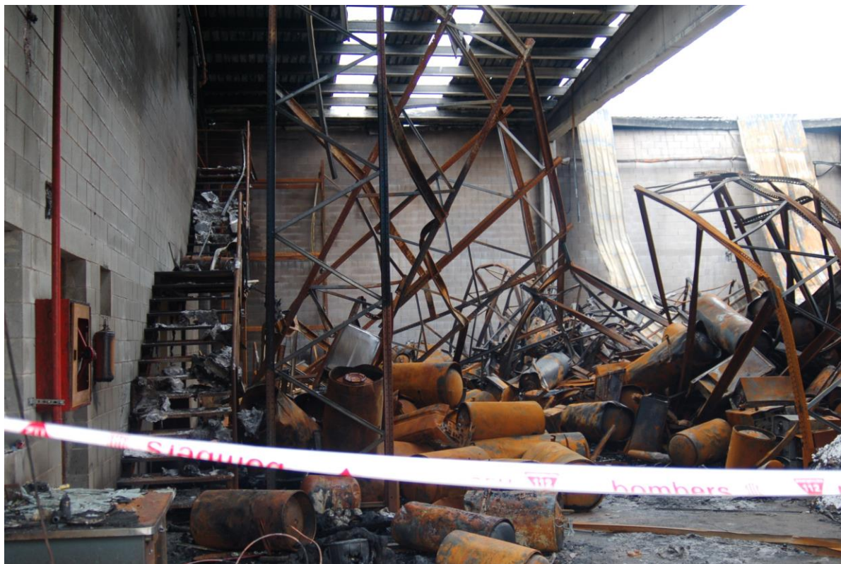
Fotografia 9: Danys en mercaderies i estructura de la nau planta baixa
