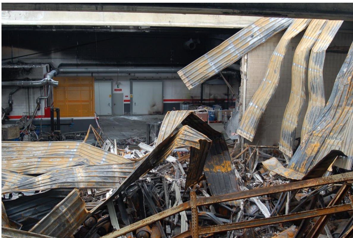
Fotografia 6: Danys en coberta metàl·lica i parets divisòries planta baixa
