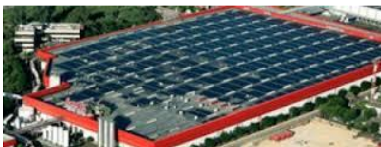
Fig. 6.4. Imagen de una cubierta con lonas fotovoltaicas
