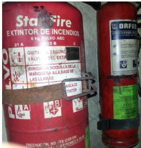
IMATGE(43) - Extintors de pols seca
