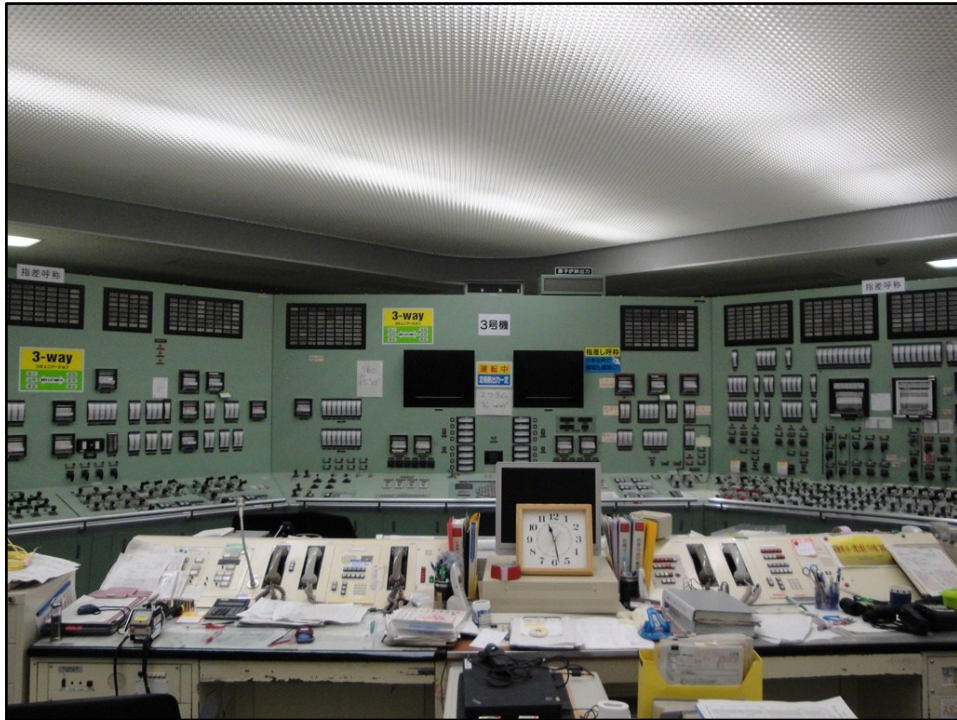
Fig. Antigua Sala de Control con paneles anunciadores de alarmas. El espacio físico del panel limitaba ya de por sí el número de alarmas que se podían implementar, por lo que estas se elegían bien.
