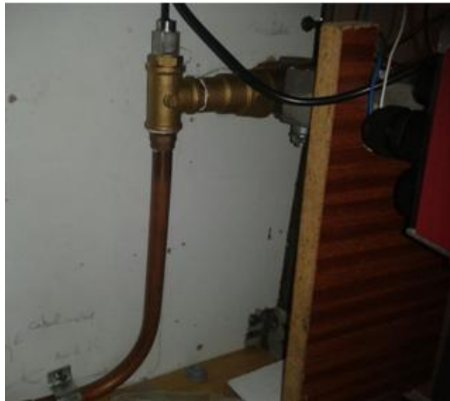
Fig. 9.2. Detall de la sortida de la vàlvula mescladora i tram per al sensor de temperatura
