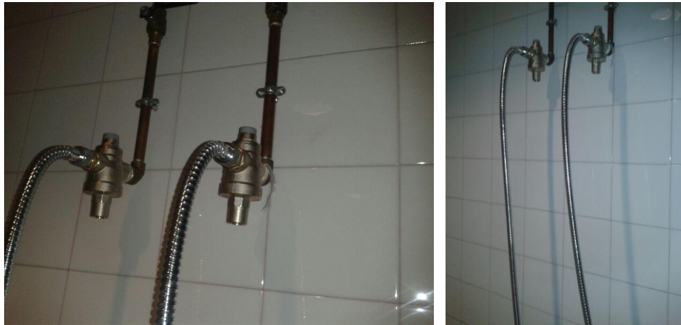
Fig. 9.5. Detall de les vàlvules reductores de pressió
