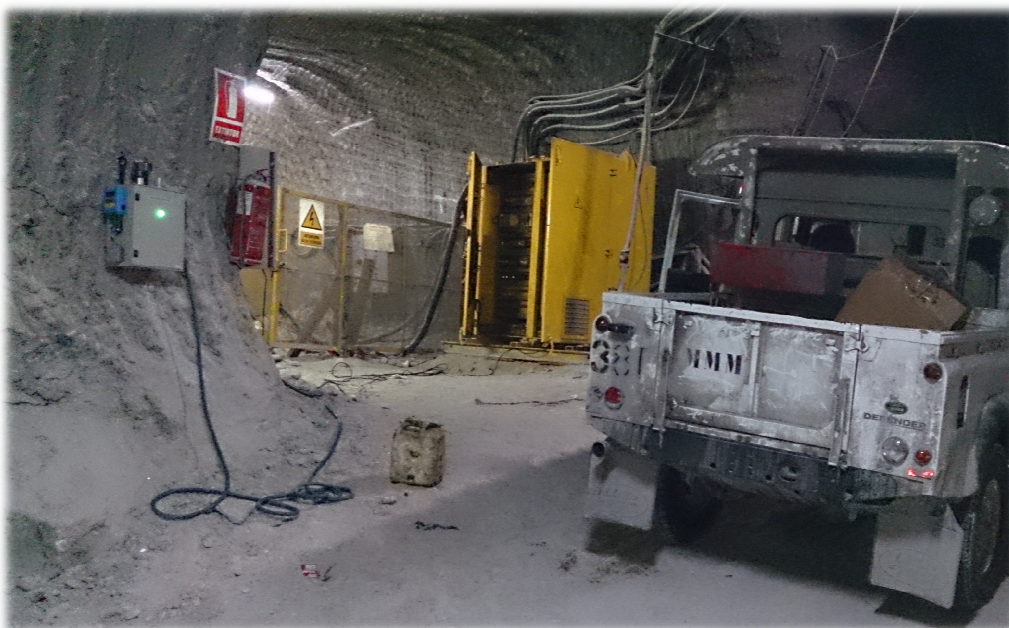
Fig21. Armari connectat al quadre de distribució
