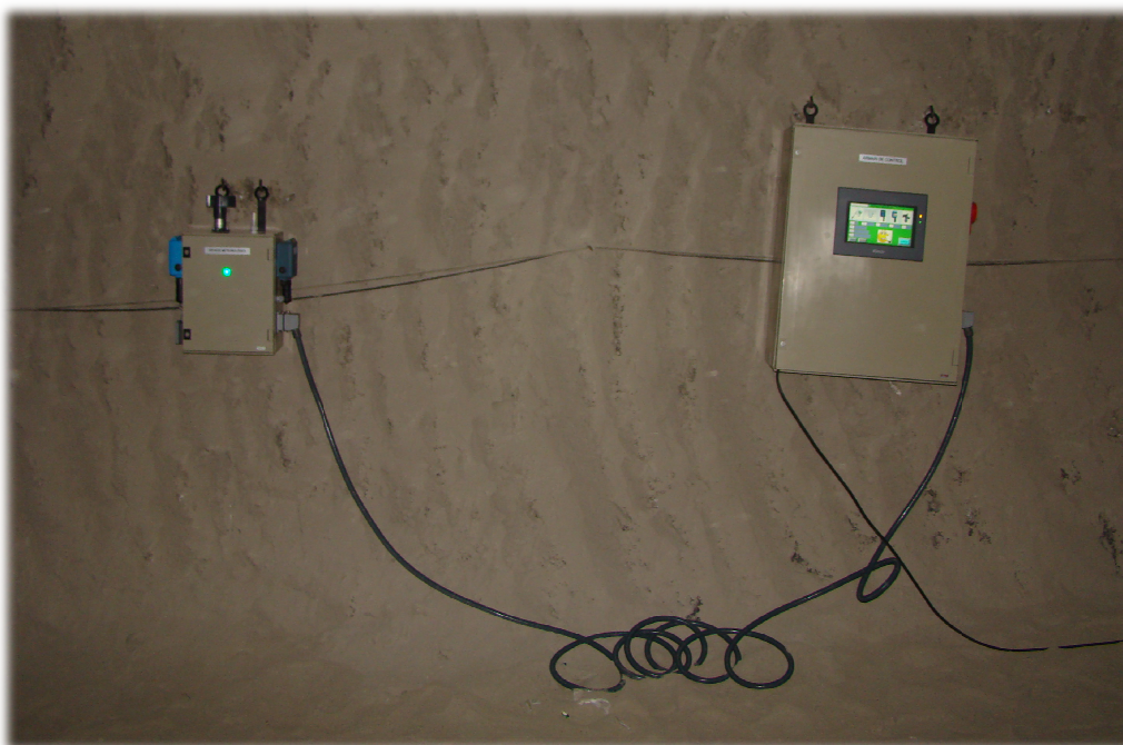
Fig22. Armari sensor i de control connectats
