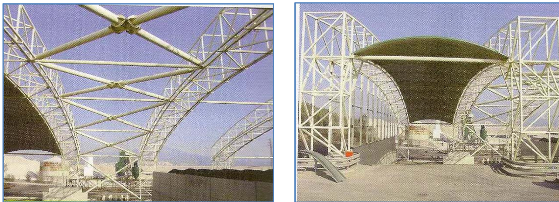
Fig. 26: Vistas de la bóveda atirantada entre los pórticos y vista de las cruces de San Andrés.
