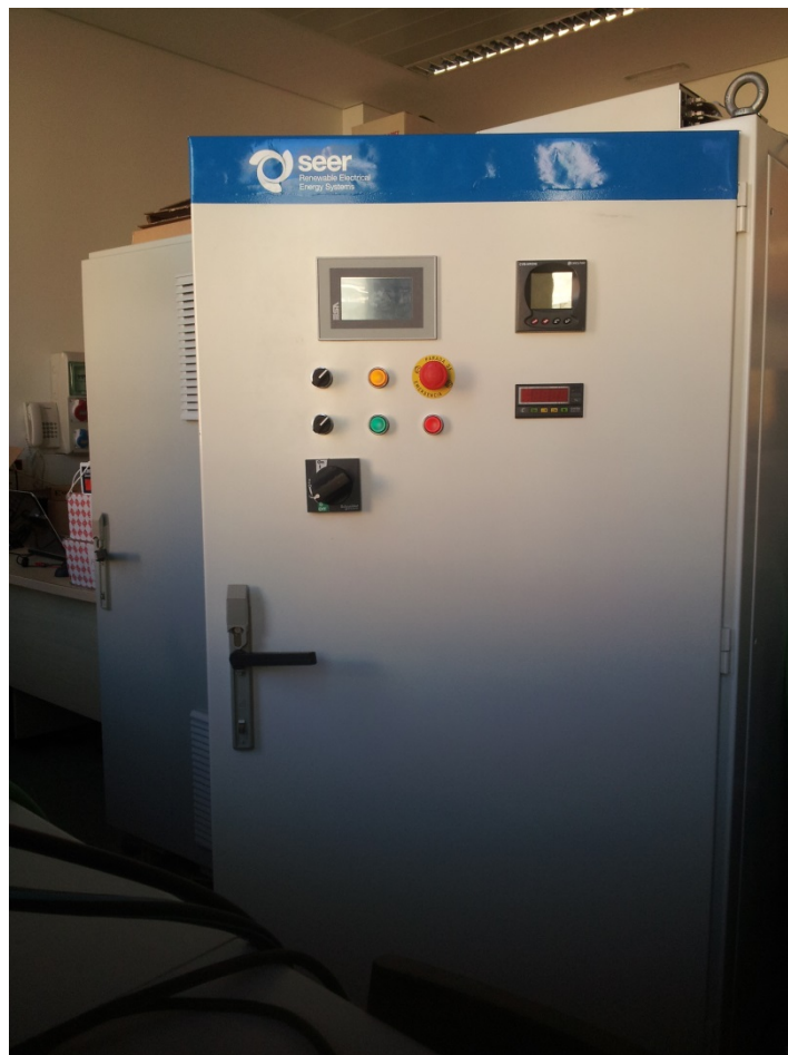
Fig. 131. Armario del inversor de 100kW.
