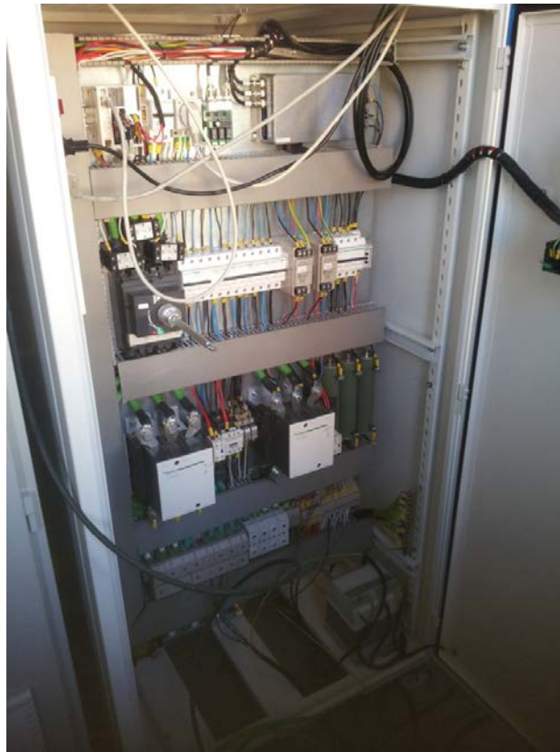
Fig. 132. Placa de montaje frontal del inversor de 100kW. Contactores y protecciones.
