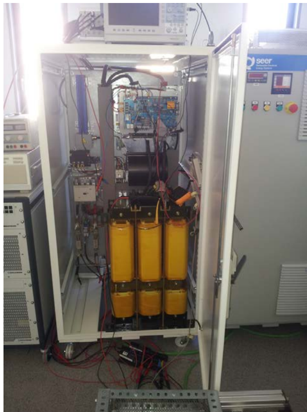
Fig. 133. Placa de montaje posterior del inversor de 100kW.
