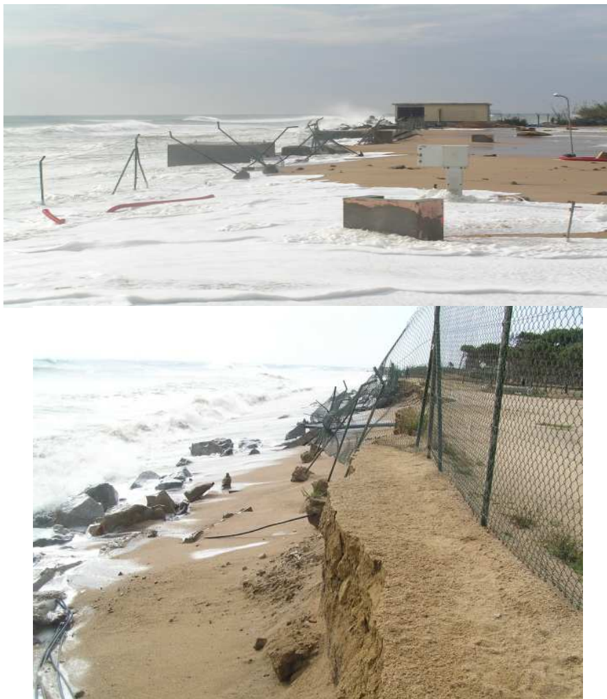
Figura 2.12. Daños en la parte Sur de la playa de s'Abanell (instalaciones de la desaladora y zona de campings).
