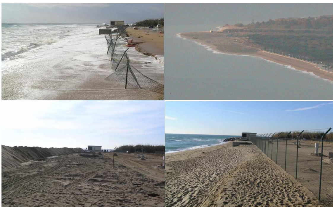
Figura 4.5. Impacto de un temporal en la parte sur de s'Abanell antes de la alimentación (octubre de 2007), alimentación en la parte sur de s'Abanell (diciembre 2007), obras de alimentación en la parte sur de s'Abanell (diciembre 2007) y situación de la parte sur de s'Abanell después de la alimentación y del impacto de un temporal (enero2008).
