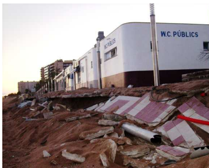
Figura 2.13. Daños en edificios.
