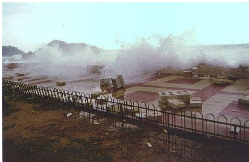
Figura 2.15. Roturas y descalce en diferentes partes del paseo marítimo de s'Abanell.
