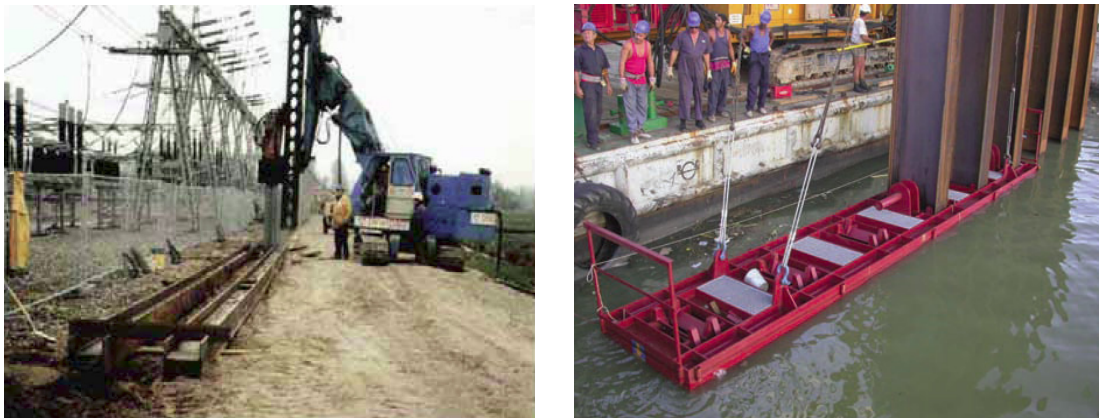
Figura 28: Guía inferior y poste de hincada (izquierda) y plantilla de pilotes guía (derecha)
