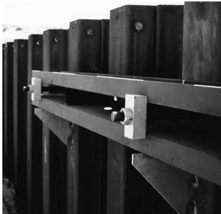
Figura 12: Cartelas de soporte de vigas de reparto
