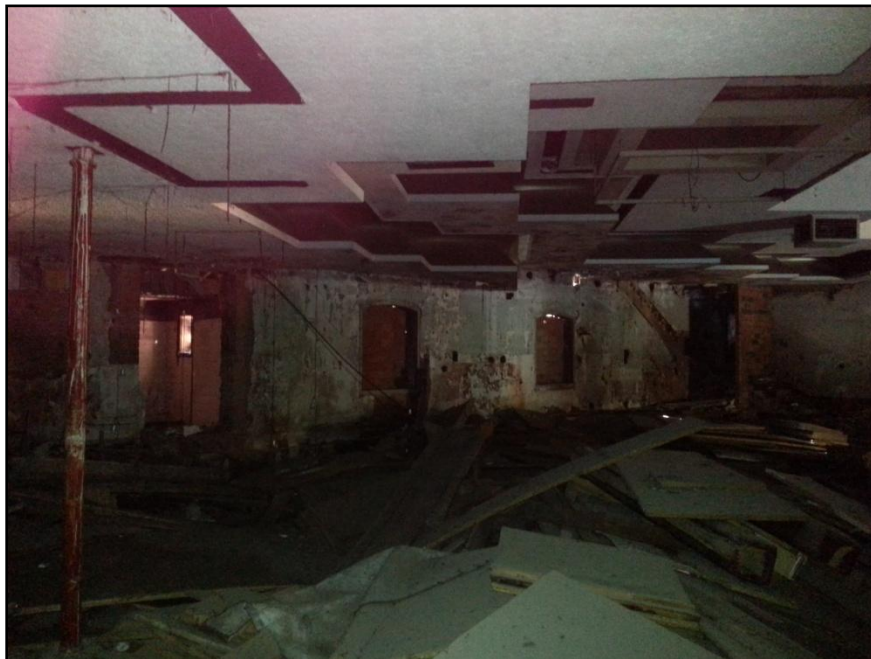
Fotografía del interior de la sala teatro, tomada desde la planta baja, donde podemos observar uno de los pilares que aguantaba la tribuna.
