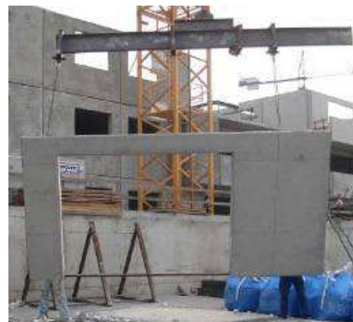
Montaje del sistema BSCP, Edificio de viviendas en Granollers, Barcelona. (Documentación MUTA)
