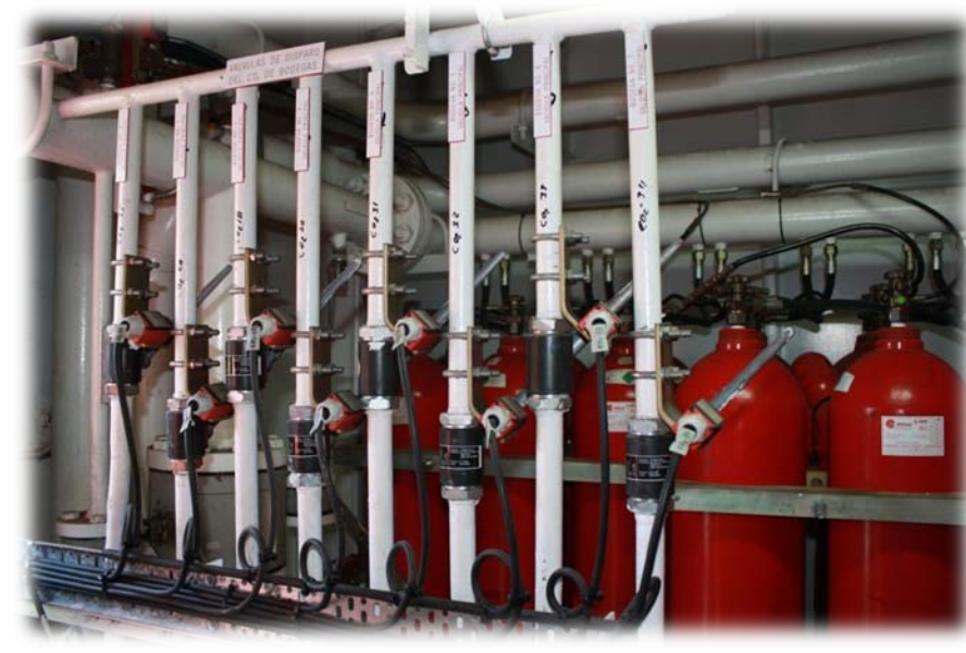
Ilustración 5. Válvulas de accionamiento para la extinción en bodegas
