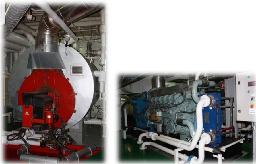
Ilustración 1. Vista de la caldera y de uno de los motores auxiliares.
