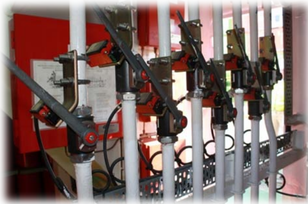
Ilustración 6. Válvulas de accionamiento del sistema de CO 2
