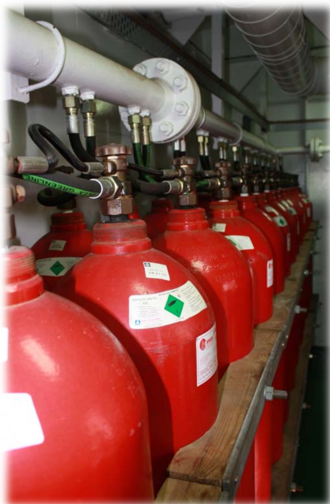
Ilustración 7. Almacenamiento de botellas de CO 2
