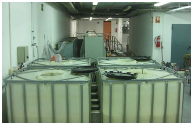
Il·lustració 1. Vista lateral de les instal·lacions.
