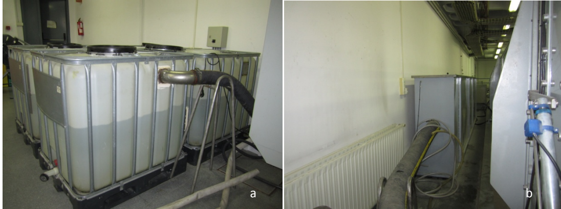
Il·lustració 5. a) Conducció Bomba 2- Dipòsit 2 b) Conducció Decantador- Bomba 2.
