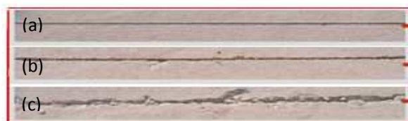
Figura 2.14 Grado de endurecimiento óptimo de corte de junta. (a) Corte óptimo (b) Corte temprano aun aceptable (c) Corte muy temprano (Modificado de Sánchez Acevedo, 2011)
