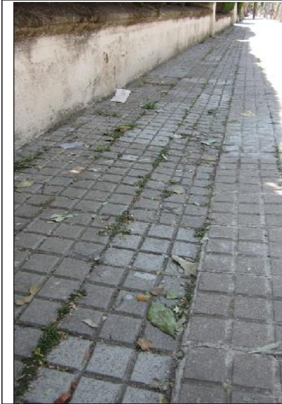
Imatge 7 : Estat del paviment de l'Avda. Eduard Corbella vorera sud. Es pot observar el mal estat del panot hidràulic i com estan creixent males herbes a les juntes.
