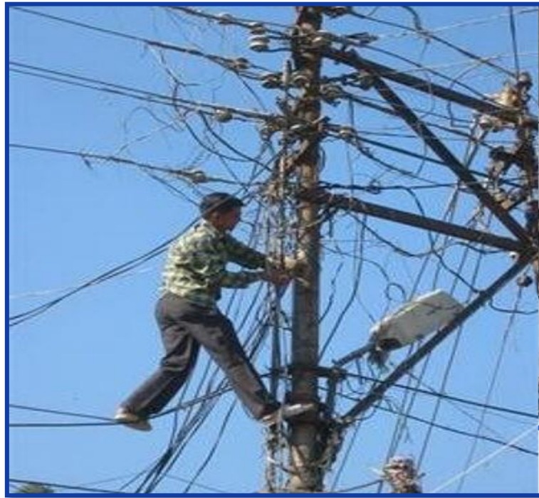
Figura 1.2 Robo de electricidad.
