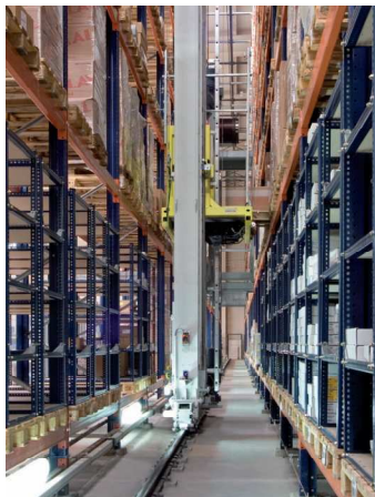
Ilustración 16: Transelevadores, modelo SIEMENS DEMATIC
