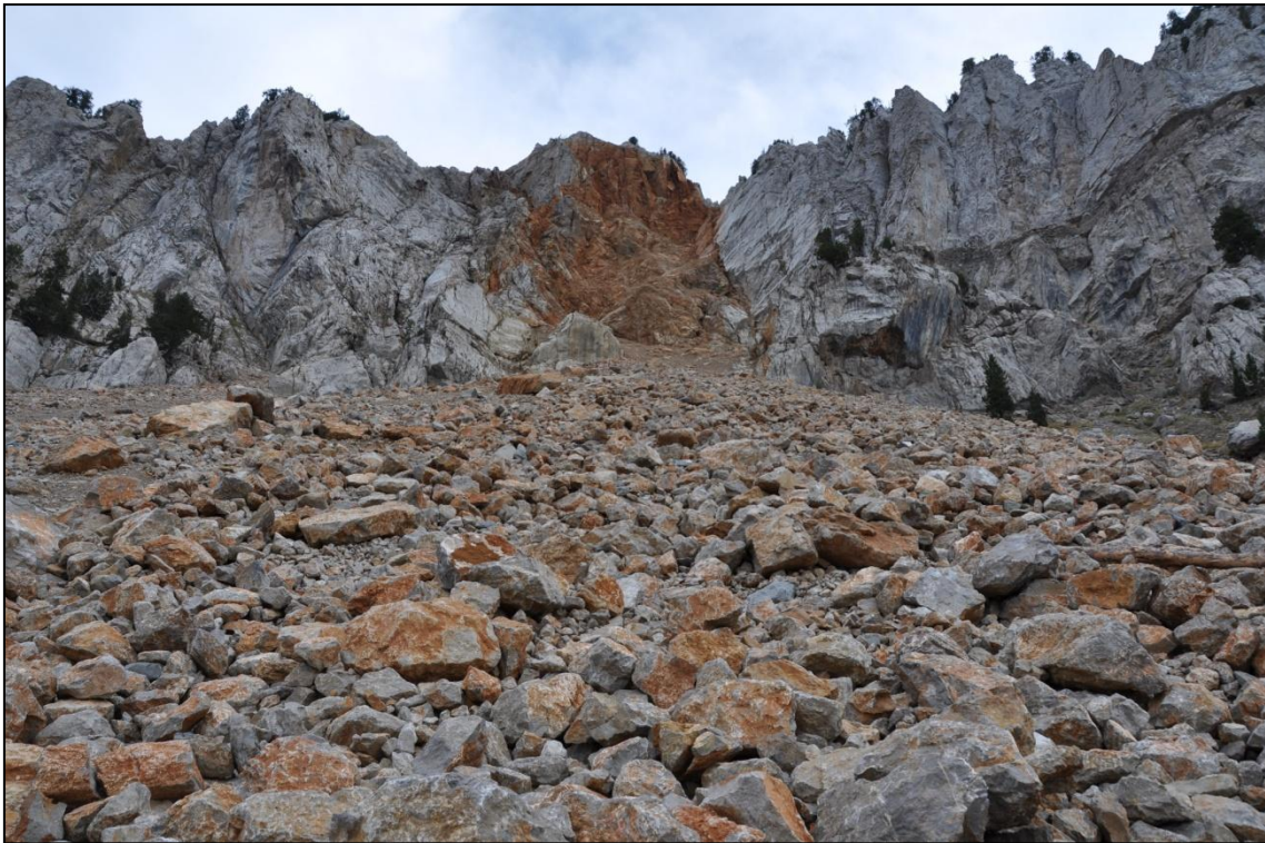
Fig. 53: Imatge de la zona on es va dur a terme el SP1 mirant cap a l'escarpament.
