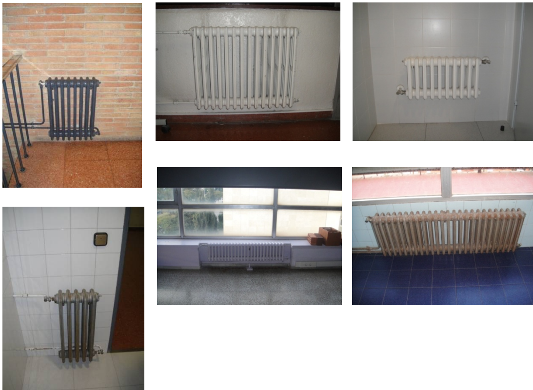
Figura 3.12: Emisores de calefacción
