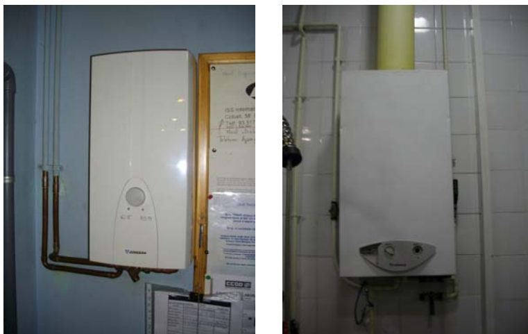
Figura 3.14: Calentador eléctrico y de gas
