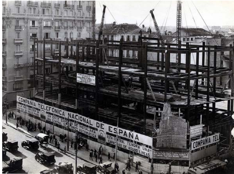
Edificio Telefónica en construcción. Contraste entre el moderno sistema estructural y la piel que finalmente lo revestiría.
