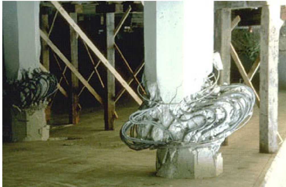
Northridge1994. Un sistema constructivo problemático. Falta de confinamiento de la armadura.
