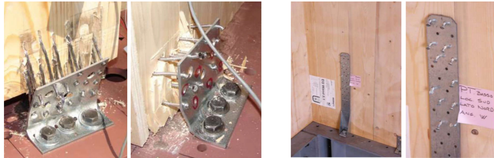
Daños en pletinas en tests de FPIinnovations y de Sofie project
