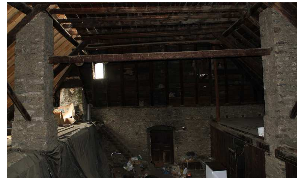
Vista Planta Segona i forat on hi va l'escala i les encavallades
