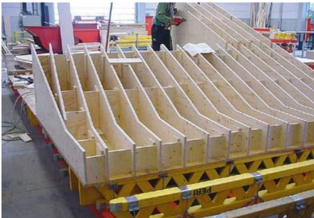
[fig.69,70] Sistema de encofrado para el Museo Mercedes Benz. Stuttgart, Alemania. UNStudio, 2001-2006.
