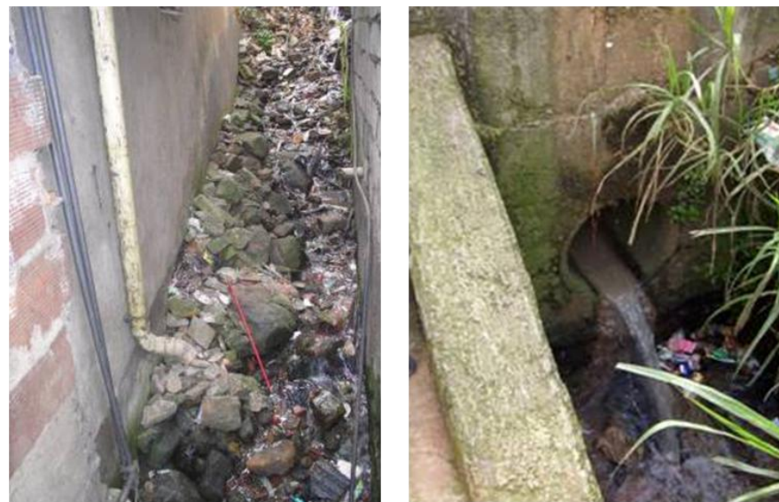
Figura 52: Sistema de alcantarillado existente en la zona, y nacimiento de la quebrada La Herrera. Fuente: (Secretaría del Medio Ambiente de Medellín, 2005)
