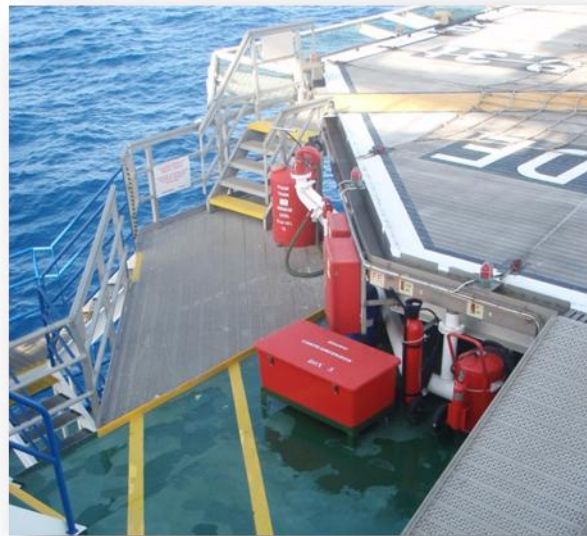
Figura 4: Estaciones lucha contraincendios y hidrante. Fuente: Elaboración propia.
