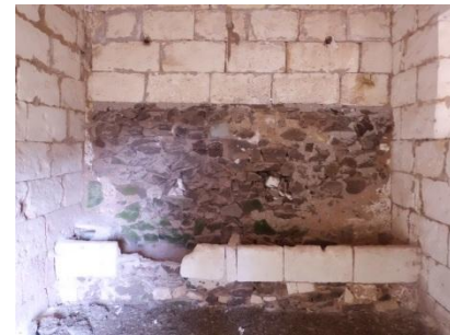
Fig.104. Mur de contenció amb discontinuïtat del material
