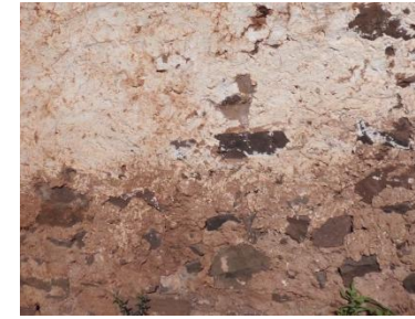
Fig.61. Revoco sobre paret de pedra
