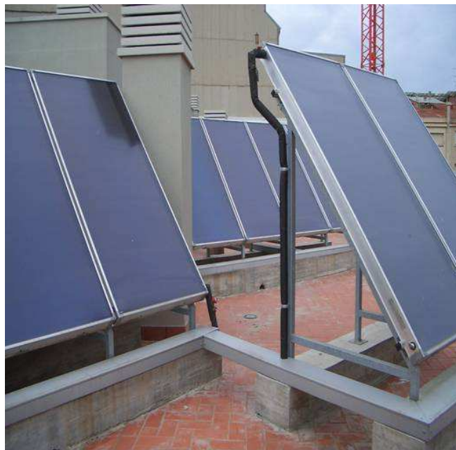
Fig. 23. Campo de captadores en disposición vertical
