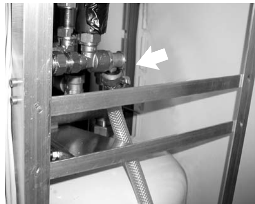
Manguera de lavado conectada al avance solar
