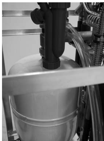
Depósito de expansión y la tubería de escape
