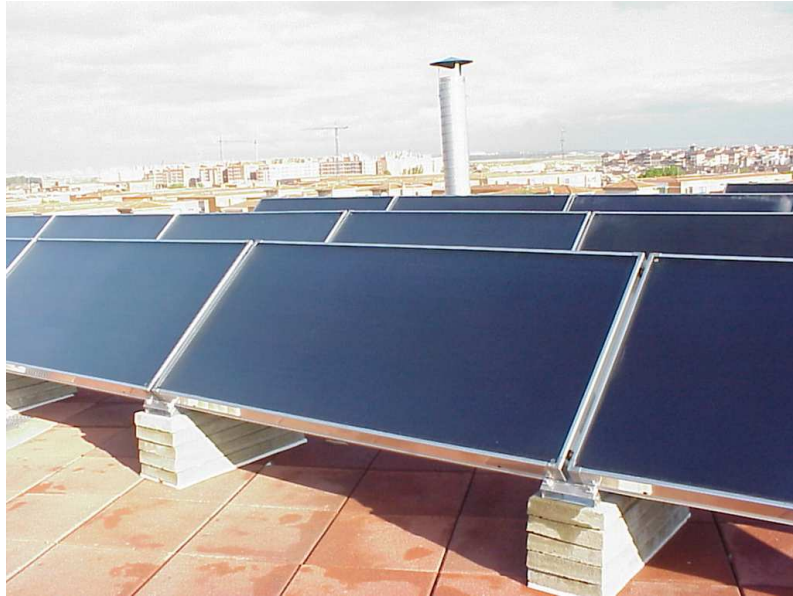
Fig. 22. Campo de captadores en disposición horizontal simple
