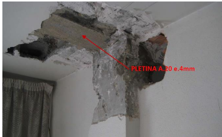
Figura 3-12. Vista inferior cata en jácena.
