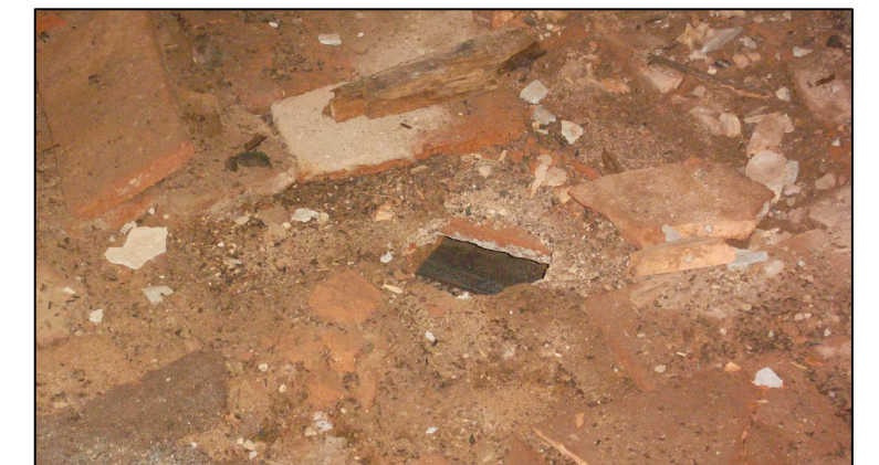
DETALL DE L'ORIFICI APAREGUT EN EL PAVIMENT
