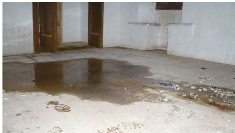
Imatge 172: Acumulació d'aigua en el terra de l'habitació 9
