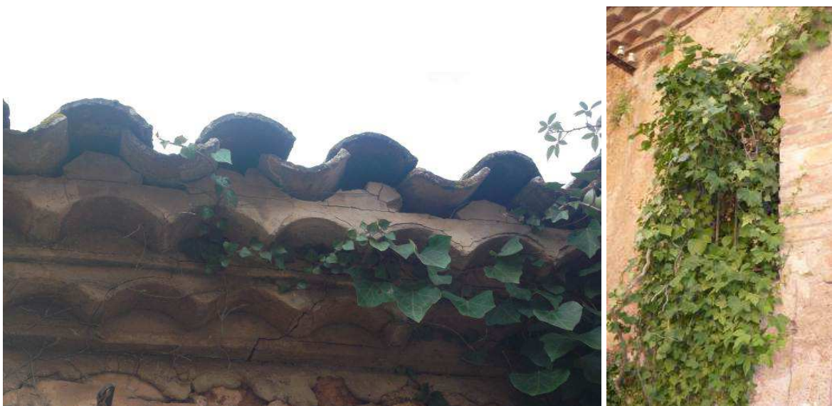
Imatges 189 i 190: Vegetació en el ràfec de coberta i una finestra
