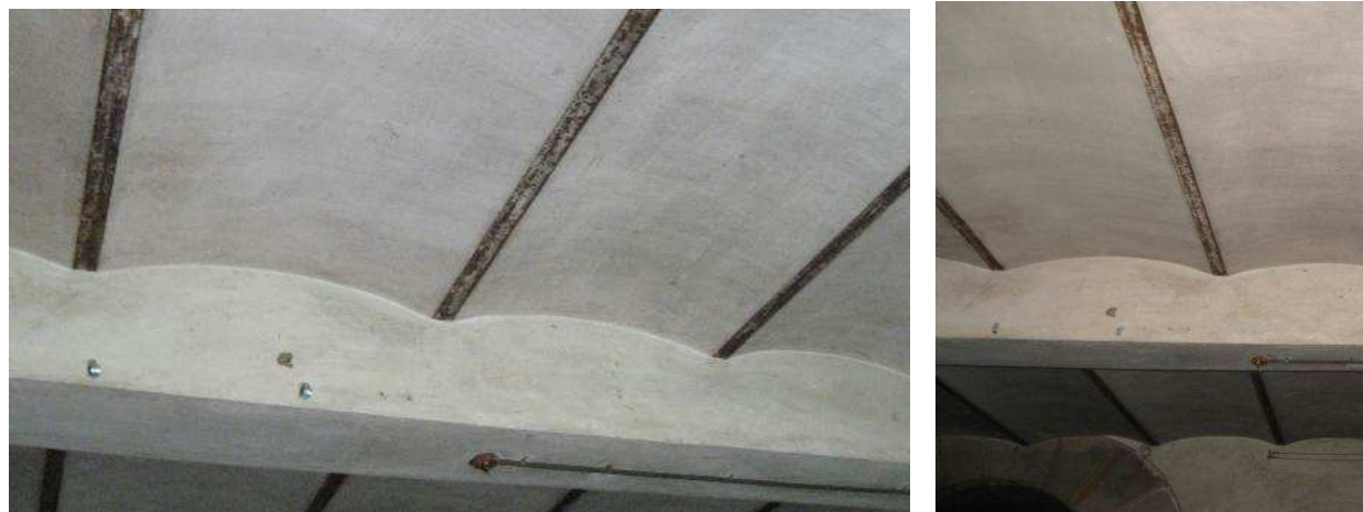
Imatges 136 i 137: Biguetes d'ala estreta afectades per les humitats en la seva ala inferior
