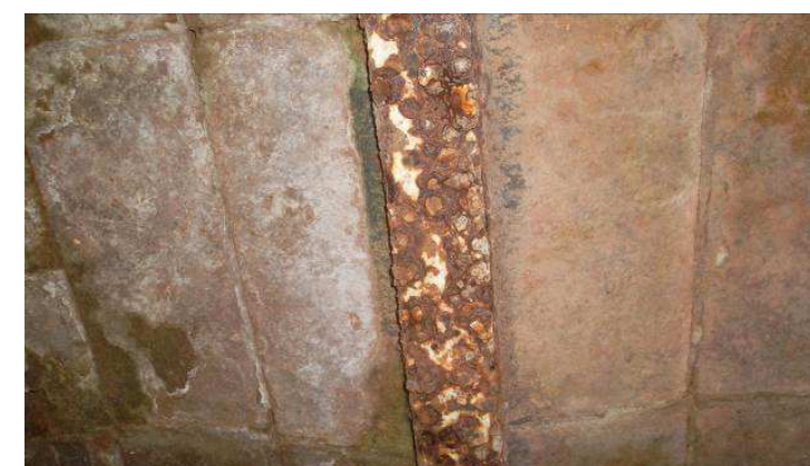
Imatges 191-192-193: Estat del perfil metàl·lic
