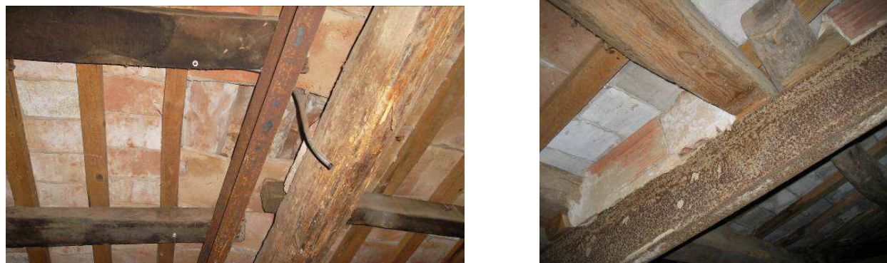
Imatges 162 i 163: Perfils metàl·lics d'ala estreta afectats per la corrosió
