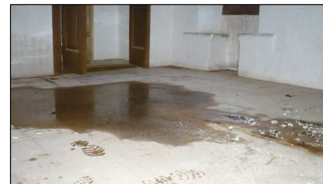
ACUMULACIÓ D'AIGUA EN EL PAVIMENT DE PLANTA PRIMERA
