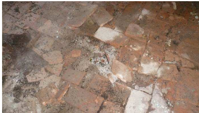
Imatge 168: Orifici en el paviment de sotacoberta que permet el pas de l'aigua per filtracions
