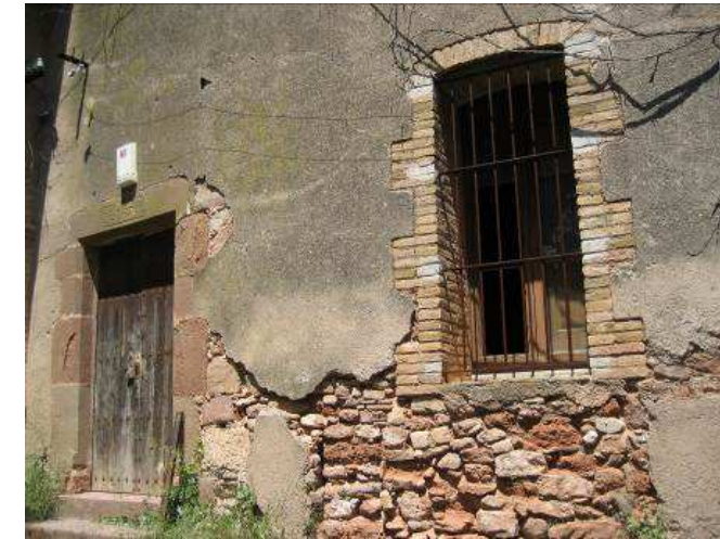
Imatge 187: Despreniments de façana (pati interior de planta primera)
