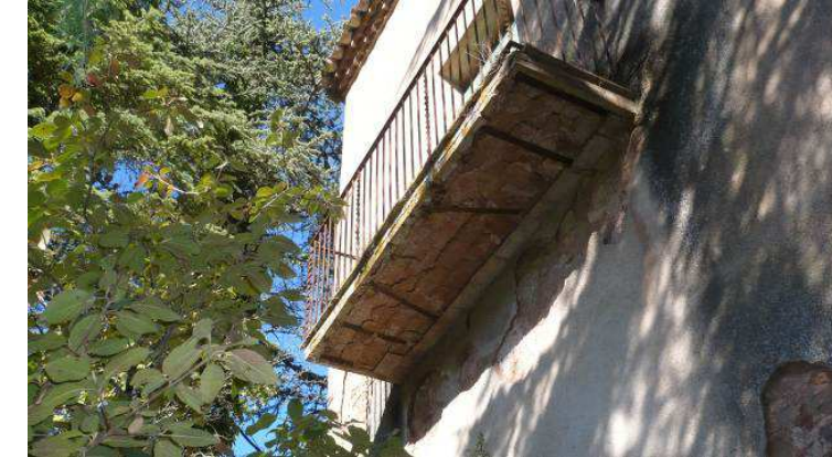
Imatge 198: Estat del balcó per la seva cara inferior
