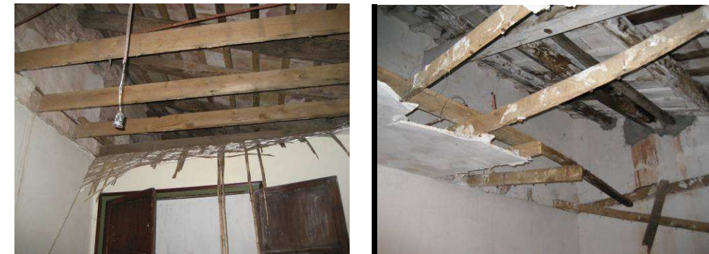
Imatges 146 i 147: Despreniments del cel ras
