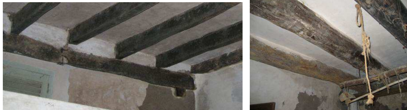
Imatges 130 i 131: Humitats en bigues de fusta
