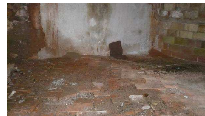
Imatge 171: Estat del paviment de la planta sotacoberta en la zona afectada
