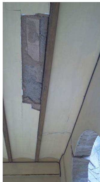
Imatge 186: Prolongació de l'esquerda fins al forjat i despreniment de l'acabat
