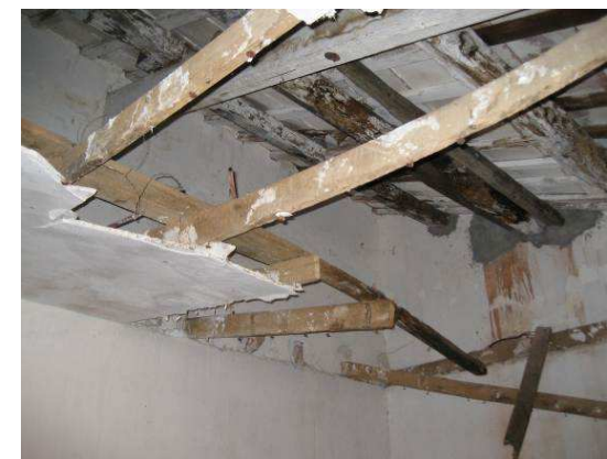
Imatge 92: despreniments del falç sostre en l'habitació 7
