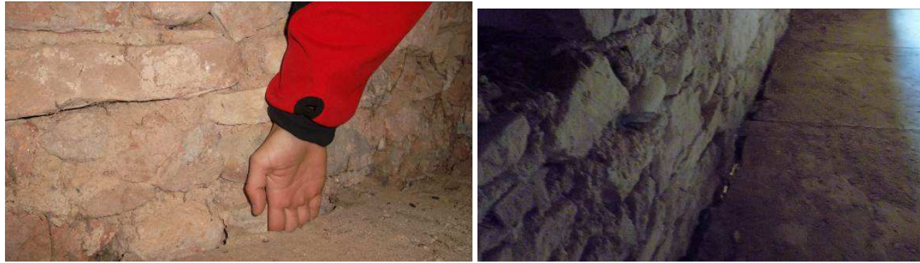
Imatges 160 i 161: Separació entre el forjat i mur de façana
