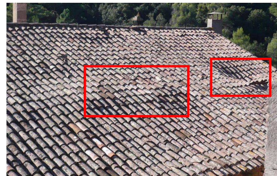
Imatges 177 i 178: Esfondraments de la coberta
