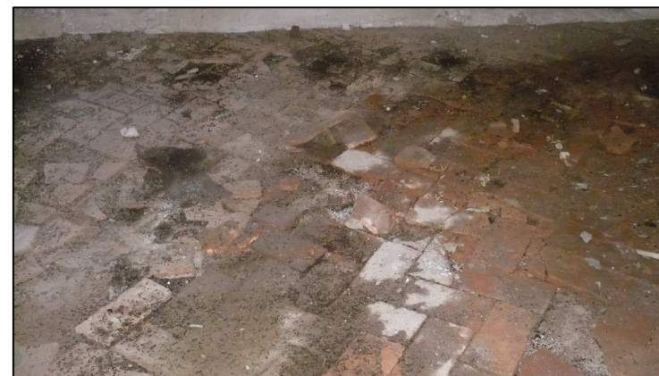
ESTAT DEL PAVIMENT
