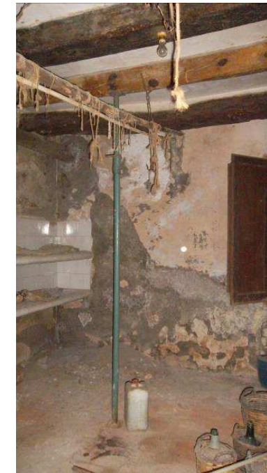
Imatge 132: Reforç estructural en una biga afectada per la humitat
