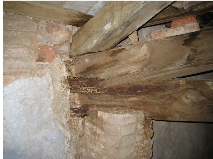
Imatge 218: Estat en què es troba el recolzament
