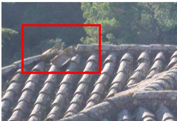
Imatge 179: Trencament de teules del carene
