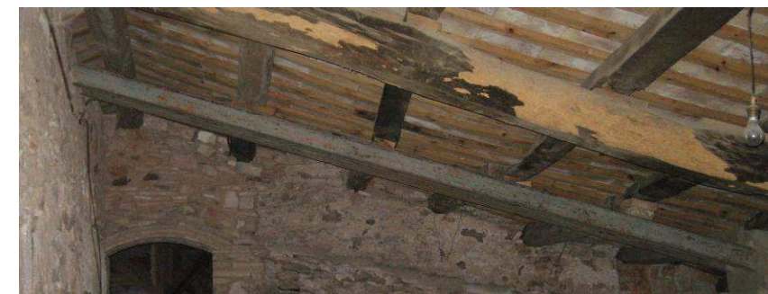
Imatge 155: Biga afectada per l'atac de corcs
