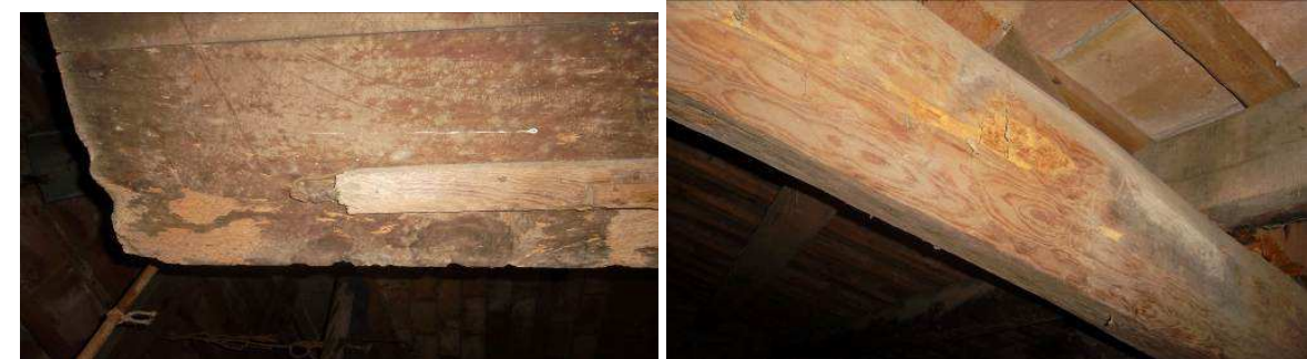
Imatges 153 i 154: Porta i biga de fusta afectades per l'atac de corcs
