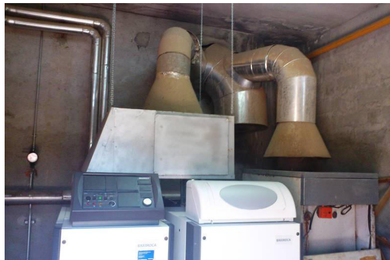
Fig.4.20: Vista conjunt calderes S. Calefacció, ACS i xemeneies Font: Elaboració pròpia
