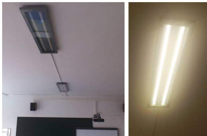
Fig.6.16: El centre cerca l'eficiència, instal·la làmpades LED Font: Elaboració pròpia – ANNEX B Arxiu fotogràfic
