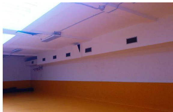
Fig.6.20: Equip ventilació planta soterrani, Gimnàs Font: Elaboració pròpia – ANNEX B Arxiu fotogràfic
