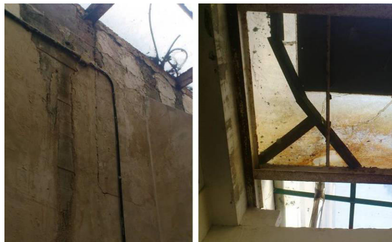
Fig.6.3: Lluerna deteriorada, lesions al mur, espai Bugaderia Font: Elaboració pròpia – ANNEX B Arxiu fotogràfic
