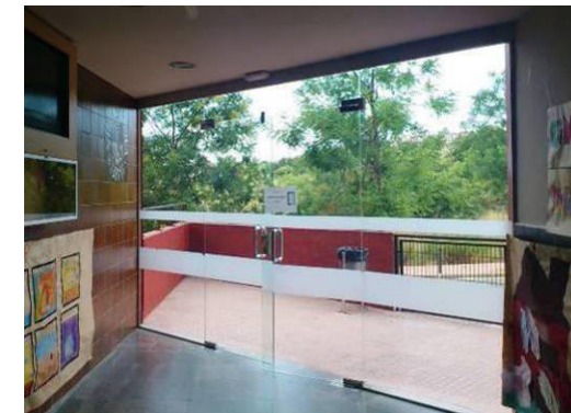
Fig.6.11: Accessos edifici, vestíbul doble fusteria Font: Elaboració pròpia – ANNEX B Arxiu fotogràfic
