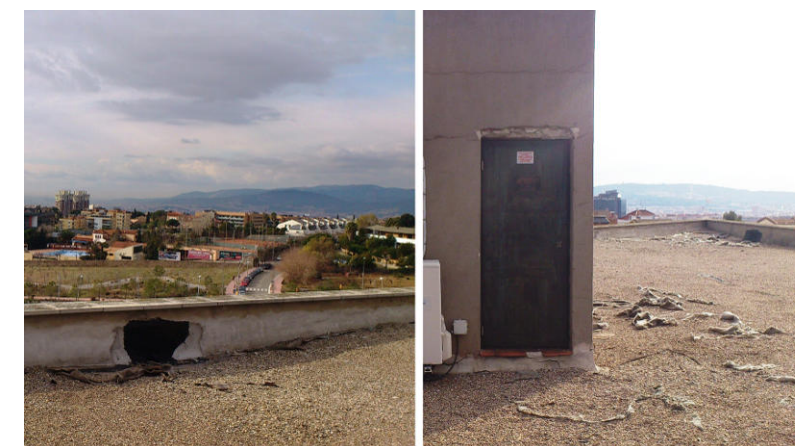
Fig.6.8: Coberta transitable necessitat de manteniment Font: Elaboració pròpia – ANNEX B Arxiu fotogràfic
