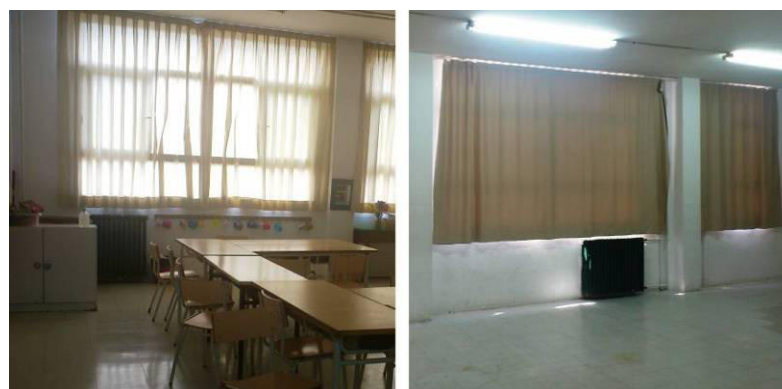
Fig.6.7: Façana sud, manca de protecció solar per l'exterior Font: Elaboració pròpia – ANNEX B Arxiu fotogràfic
