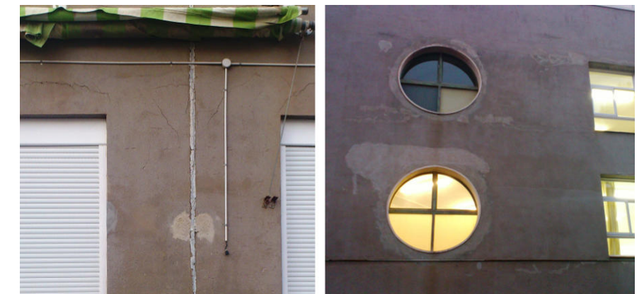
Fig.6.5: Façana de doble fulla, irregularitats en el revestiment Font: Elaboració pròpia – ANNEX B Arxiu fotogràfic
