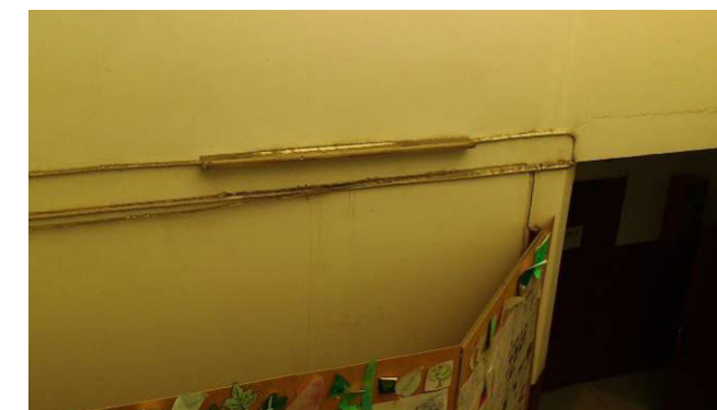
Fig.6.14: Manca de neteja, situació de risc personal neteja Font: Elaboració pròpia – ANNEX B Arxiu fotogràfic
