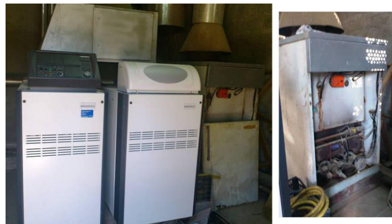
Fig.6.17: Equip de calderes per calefacció, Equip obsolet Font: Elaboració pròpia – ANNEX B Arxiu fotogràfic
