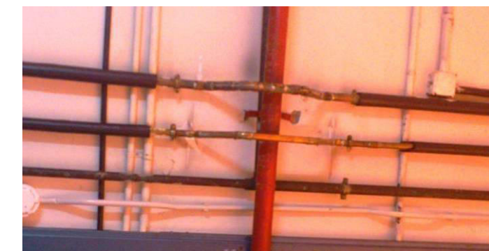
Fig.6.18: Discontinuitat en l'aïllament dels conductes d'ACS Font: Elaboració pròpia – ANNEX B Arxiu fotogràfic
