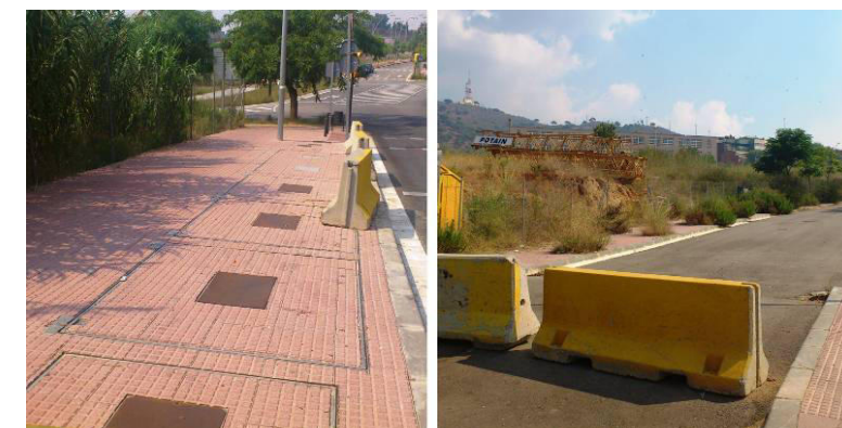
Fig.6.23: Tasques d'urbanització, recollida de residus sense servei Font: Elaboració pròpia – ANNEX B Arxiu fotogràfic
