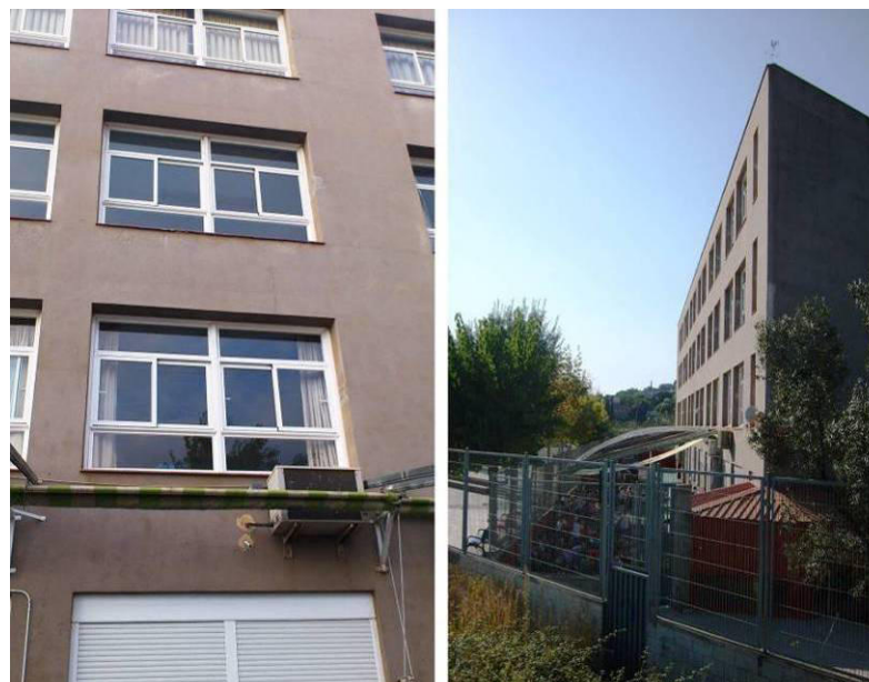
Fig.6.6: Façana sud, manca de protecció solar per l'exterior Font: Elaboració pròpia – ANNEX B Arxiu fotogràfic
