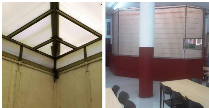
Fig.6.9: Lluerna de policarbonat de doble cel·la, infiltracions Font: Elaboració pròpia – ANNEX B Arxiu fotogràfic
