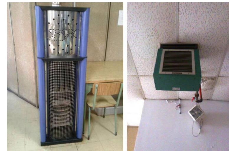
Fig.4.23: Caldera gasoil menjador, ventiloconvector anul·lat Font: Elaboració pròpia
