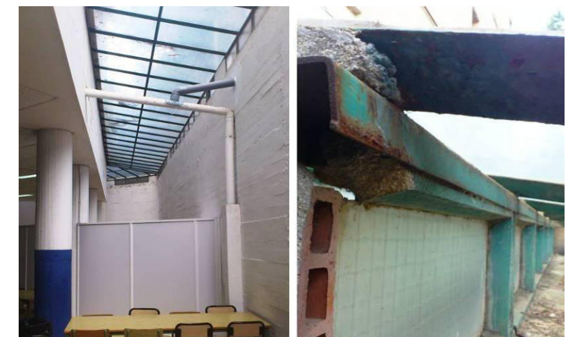
Fig.6.1: Lluerna inclinada soterrani – Cuina, Menjador Font: Elaboració pròpia – ANNEX B Arxiu fotogràfic
