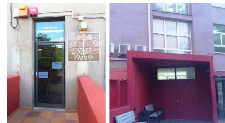
Fig.6.12: Accessos edifici, pèrdua d'estanquitat Font: Elaboració pròpia – ANNEX B Arxiu fotogràfic
