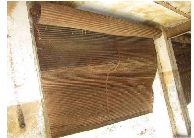
Foto 20: Porta metàl·lica tipus persiana amb oxidació i deformacions.
