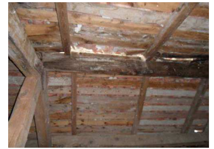
Foto 18: Podridió de la fusta en el carener de l'edifici F. Font: Grup 2 DAC - Rehabilitació.
