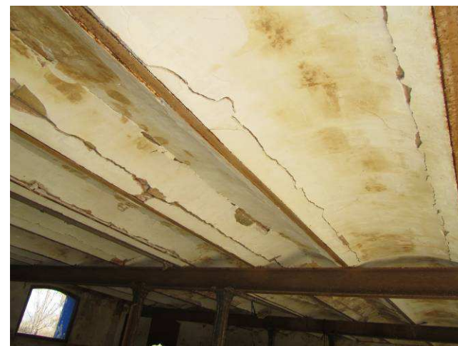
Foto 5: Esquerdes longitudinals en la part inferior del forjat, provocades per la dilatació de les biguetes.
