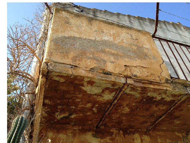
Foto 9: Bigues de ferro amb oxidació, en la part inferior del replà
