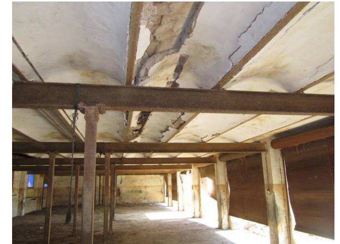
Foto 7: Trencament previ al col·lapse de la volta ceràmica i oxidació superficial dels elements verticals.
