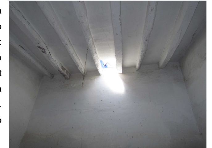
Foto 38: Discontinuitat en al coberta, causada pel trencament o desaparició d'algunes teules.
