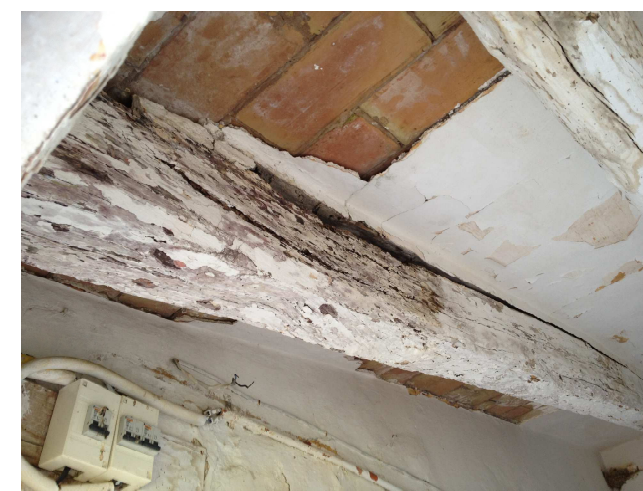
Foto 24: Bigues amb afectacions per podridió, corcs i clivelles.
