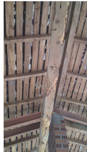
Foto 26: Afectació per corcs anòbids en un travesserer de l'estructura de fusta.
