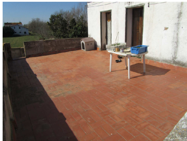
Foto 18: Enfonsament de la coberta plana transitable causada per l'acumulació d'aigua.
