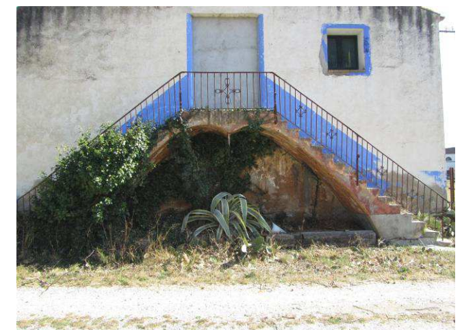
Foto 21: Vegetació invasiva en les escales de la façana Oest de l'edifici B.
