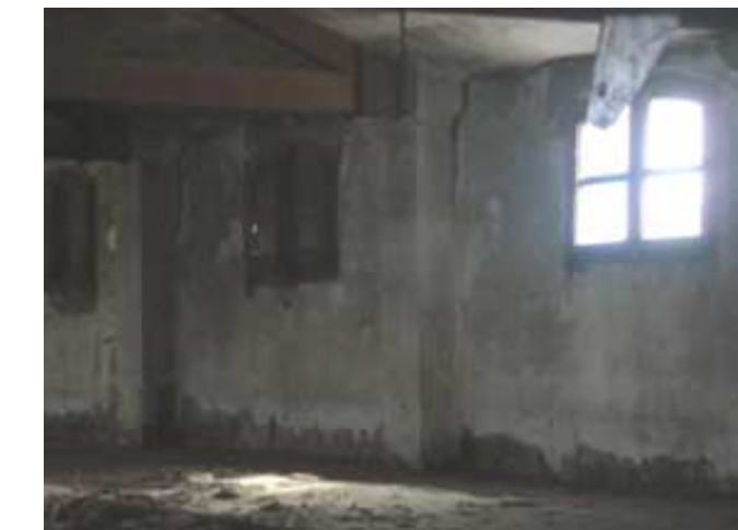
Foto 9: Esquerda en la trobada entre el mur i la pilastra. Font: Grup 1 DAC – Rehabilitació 2012
