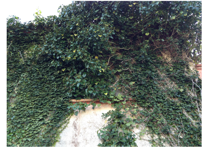
Foto 52: La vegetació (heura) envaeix els murs fins a ocultar algunes obertures.
