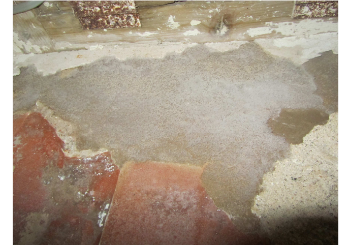
Foto 44: Aparició d'eflorescències a causa de la salinitat dels materials, l'aigua i l'ambient.
