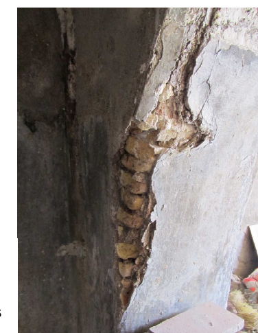
Foto 17: En PB, els moviments diferencials provoquen esquerdes i fissures entre el diferents elements.
