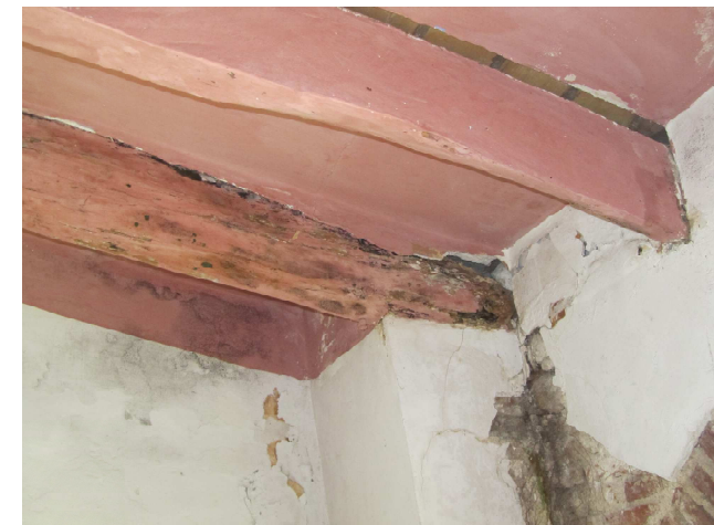
Foto 14: Podridió en la biga de fusta i moviments diferencials respecte la coberta que suporten.
