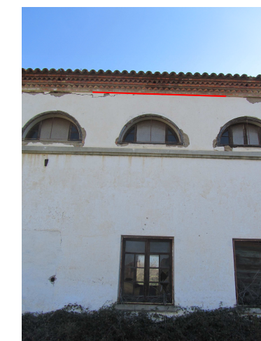
Foto 16: Esquerdes horitzontals en la trobada entre la coberta i la façana.
