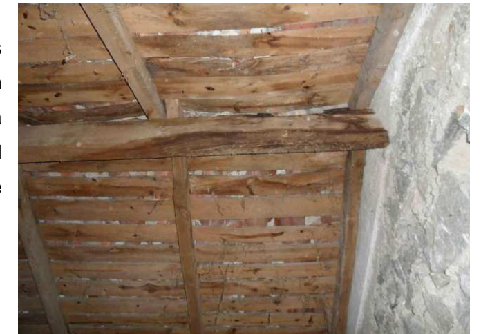
Foto 15: Podrició en l'extrem del carener, en l'annex D. Font: Grup 2, DAC-Rehabilitació, EPSEB 2012
