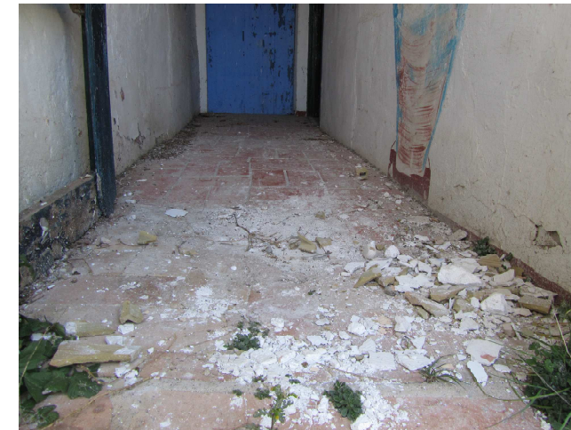
Foto 22: Enfonsament del forjat per la pèrdua de capacitat portant de les bigues.
