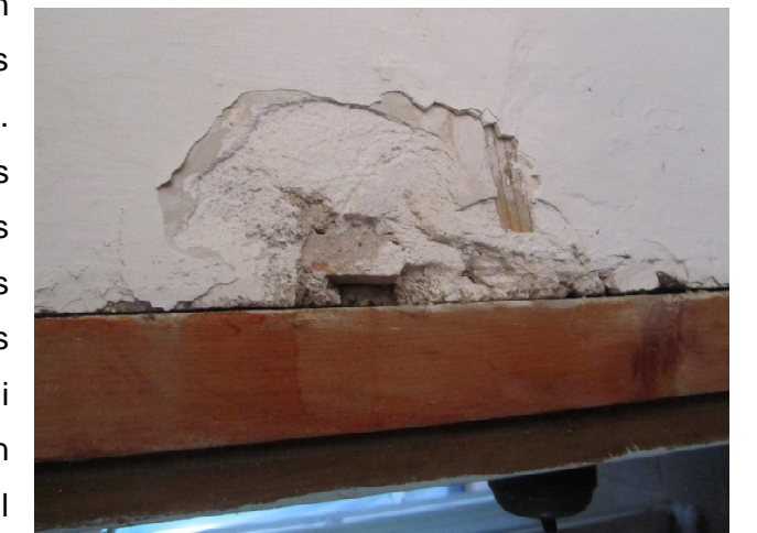
Foto 39: Fissures i trencament dels acabats interiors, en la trobada amb el marc de la porta.
