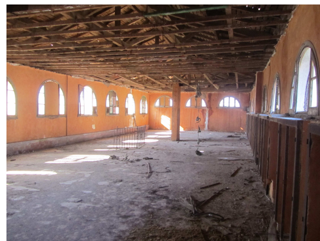
Foto 10: Interior de la planta pis, on s'hi observa el mal estat de les obertures.
