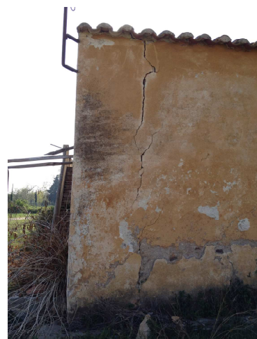
Foto 5: Esquerda vertical en la trobada entre la façana Sud i la façana Est.
