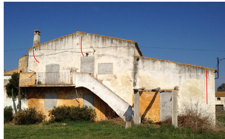
Foto 4: Esquerdes per assentaments diferencials, en la façana sud del tercer volum.
