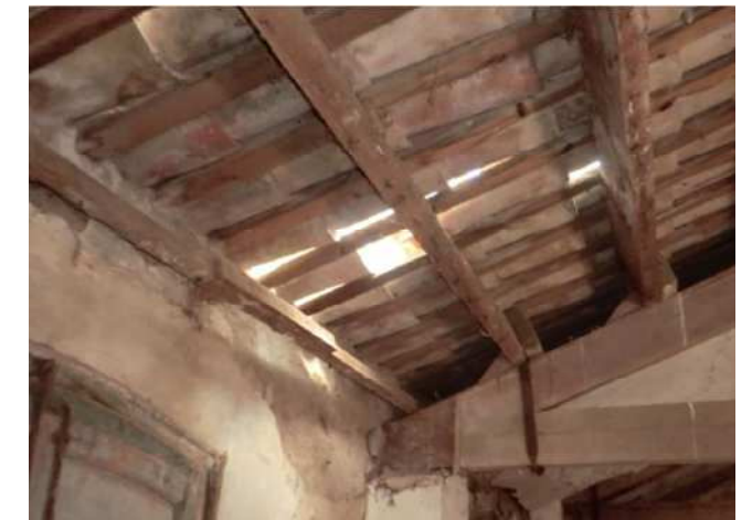
Foto 16: Discontinuitats en la coberta de l'edifici B. Font: Grup 1 DAC - Rehabilitació.
