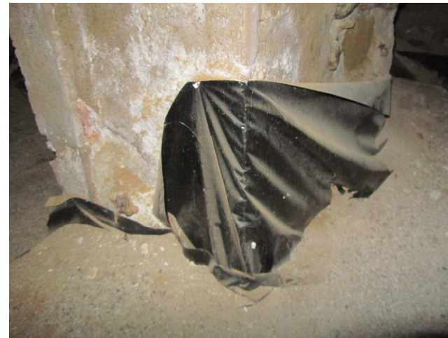
Foto 41: Lâmina impermeabilitzant en la PB del primer volum, tot i que no talla els murs.
