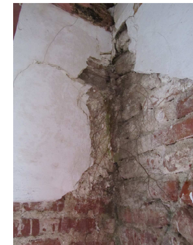
Foto 15: Esquerda vertical en la trobada entre façana i mur lateral.
