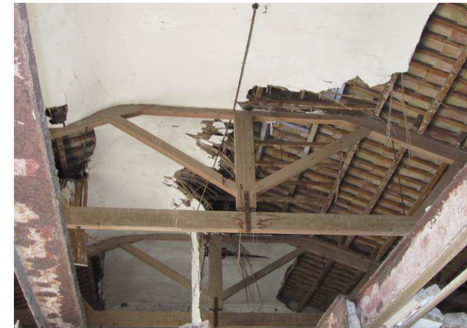
Foto 15: Trencament del fals sostre per acció de les humitats, en l'edifici B.
