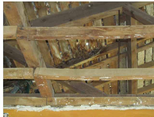
Foto 5: Podridió bruna en l'enllatat de fusta, provocada per filtracions d'aigua.
