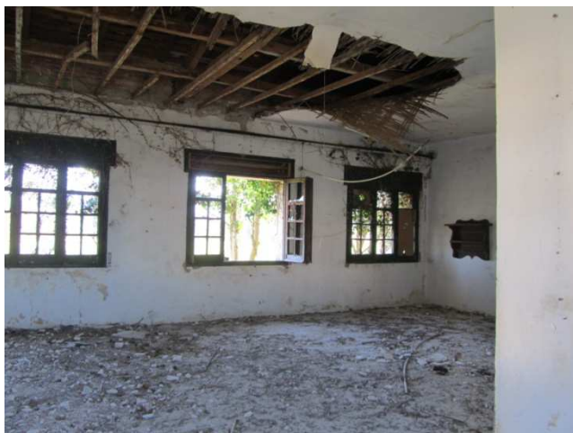
Foto 13: Interior de l'annex E, on s'hi observa el col·lapse del fals sostre.
