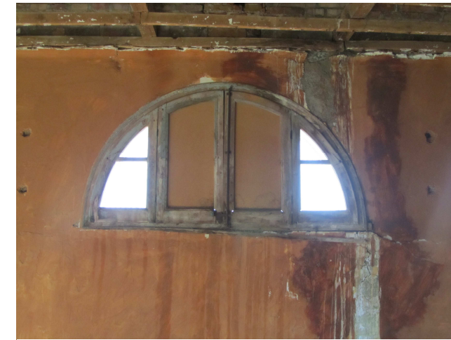
Foto 21: Humitats per filtració a través de la coberta i les fusteries, en la planta pis de l'edifici C.
