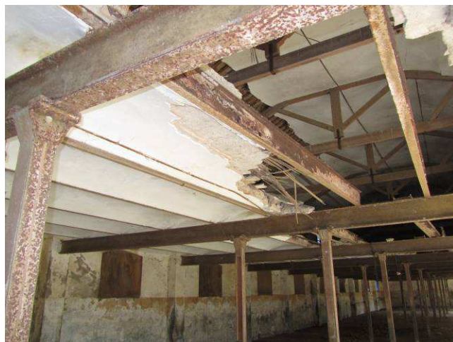
Foto 2: Forjat col·lapsat parcialment en l'edifici B.
