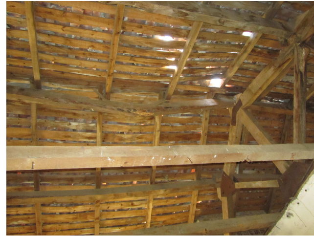
Foto 4: Discontinuitats en la coberta i trencament del carener de fusta.
