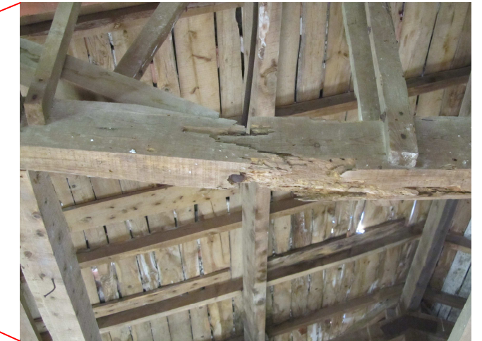
Foto 7: Detall del trencament de l'encavallada de fusta, s'observa l'atac d'insectes xilòfags.
