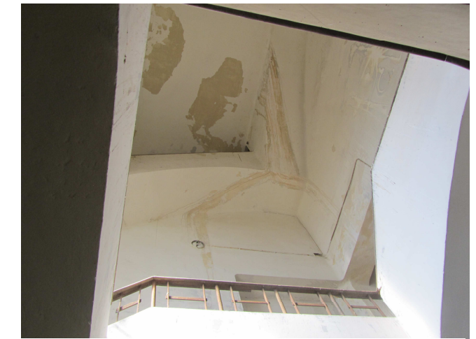
Foto 22: Les humitats provoquen el despreniment dels acabats, en la part de la torre de l'edifici C.
