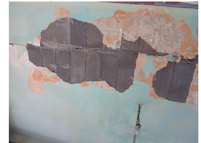
Foto 24: Les humitats provoquen despreniment de l'acabat del sostre i ataquen les biguetes de formigó armat, provocant fissures superficials.
