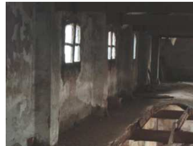
Foto 8: Planta pis de l'edifici B, on s'hi observa part del forjat afectat. Font: Grup 1 DAC – Rehabilitació 2012
