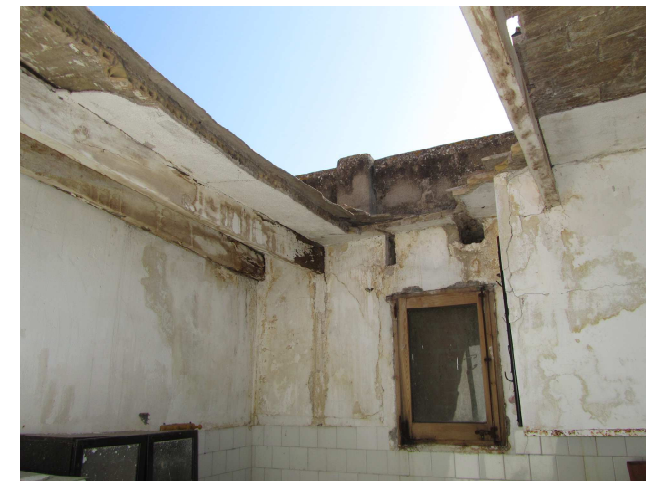
Foto 30: Col·lapse del forjat per acumulació d'aigua en la coberta plana.
