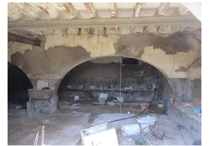
Foto 40: Exemple de desprendiment de l'arrebossat interior.
