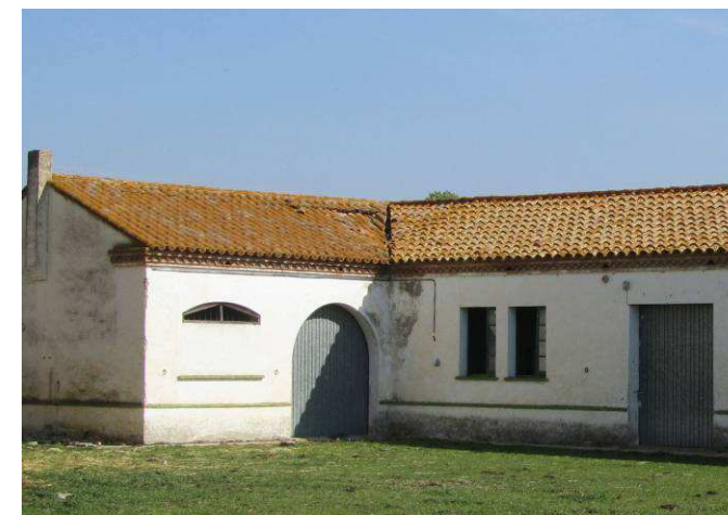
Foto 17: Enfonsament parcial de la coberta, en l'edifici F.
