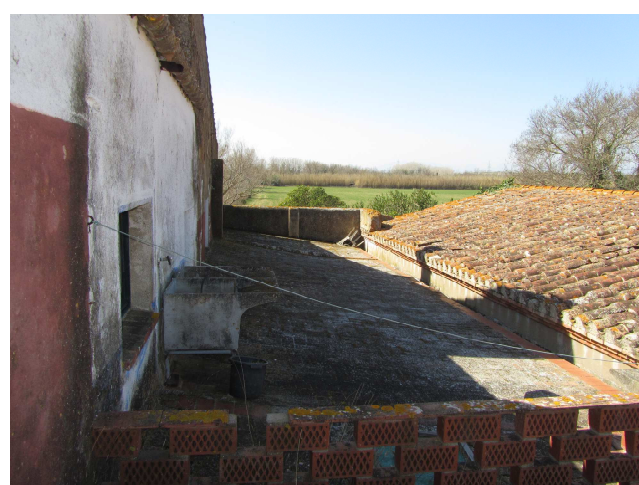
Foto 37: Vista general de la coberta plana transitable, on s'hi observa la falta de planeïtat i d'inclinació longitudinal.
