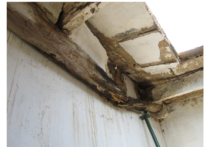
Foto 31: Trencament de les bigues de fusta que suporten la coberta plana.
