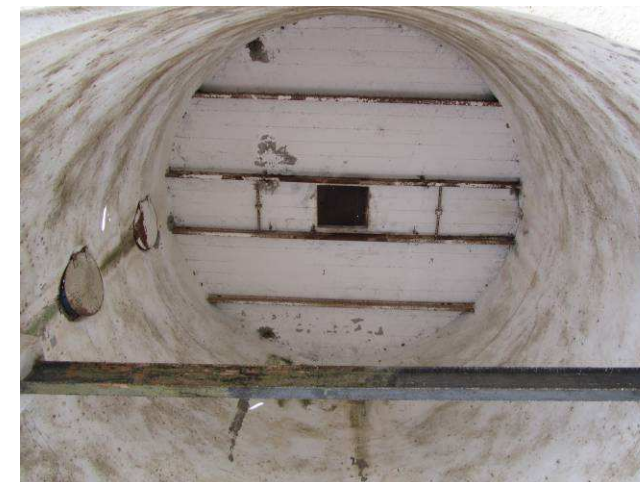
Foto 19: Oxidació superficial de les bigues en l'interior de la sitja.
