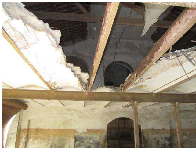
Foto 4: Trencament de les voltes ceràmiques causat per l'expansió de les biguetes.
