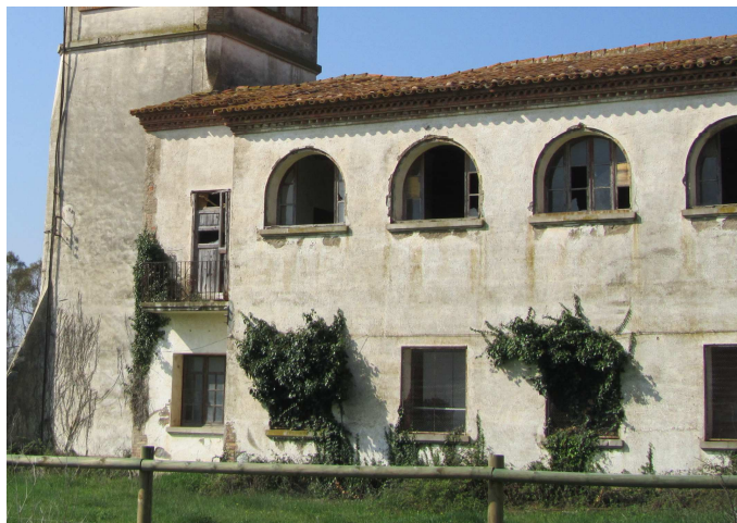
Foto 27: Vegetació invasiva en les obertures de la planta baixa de l'edifici C.
