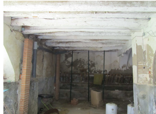
Foto 50: Afectació generalitzada per corcs, en la planta baixa del segon volum.
