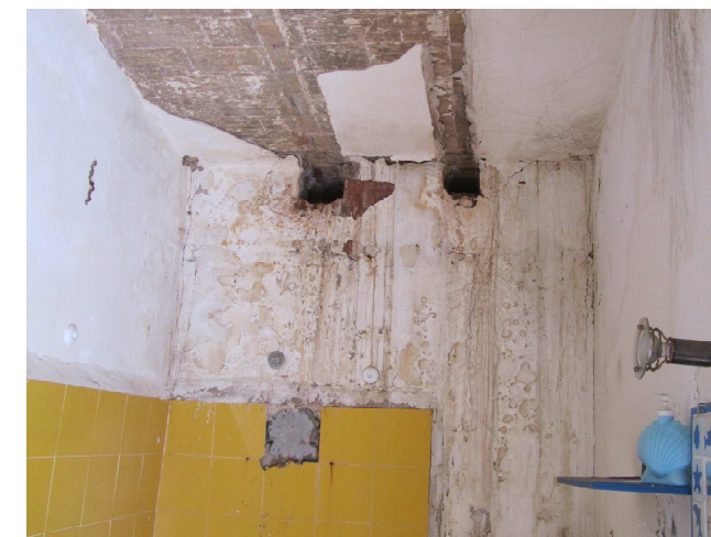
Foto 32: Manca de dues bigues de fusta i humitats per filtració.
