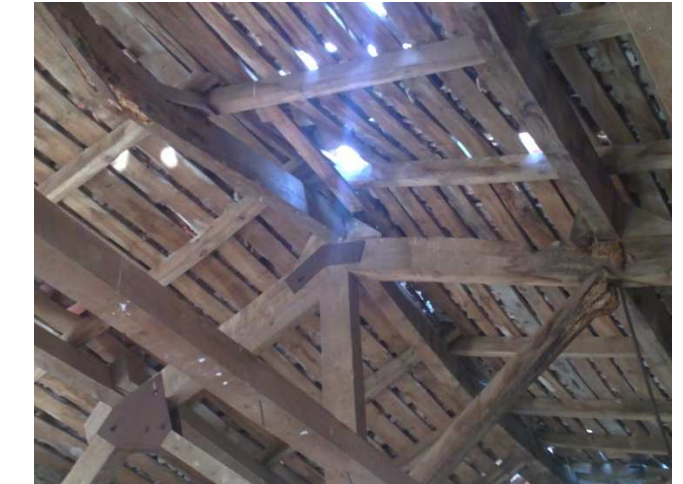
Foto 9: Discontinuitats i trencament de l'estructura de fusta que suporta la coberta.
