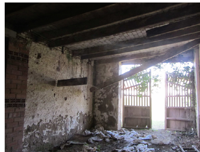
Foto 35: Col·lapse i trencament de bigues de fusta que suporten la coberta plana.
