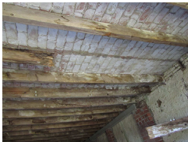
Foto 34: Trencament d'una biga de fusta causat per la sobrecàrrega i les humitats.
