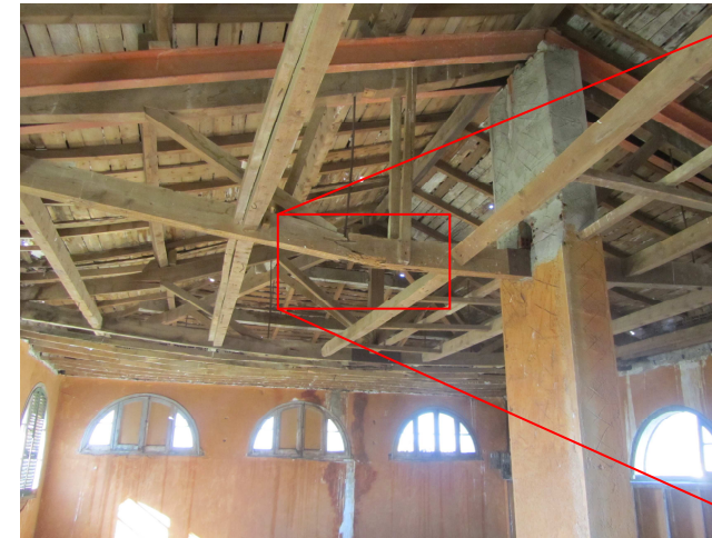
Foto 6: Trencament de l'encavallada de fusta, que ha estat reforçada amb perfil metàl·lic sobre pilar ceràmic.
