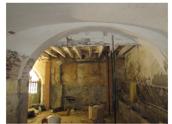
Foto 25: Vista general de la part inferior del forjat afectat.
