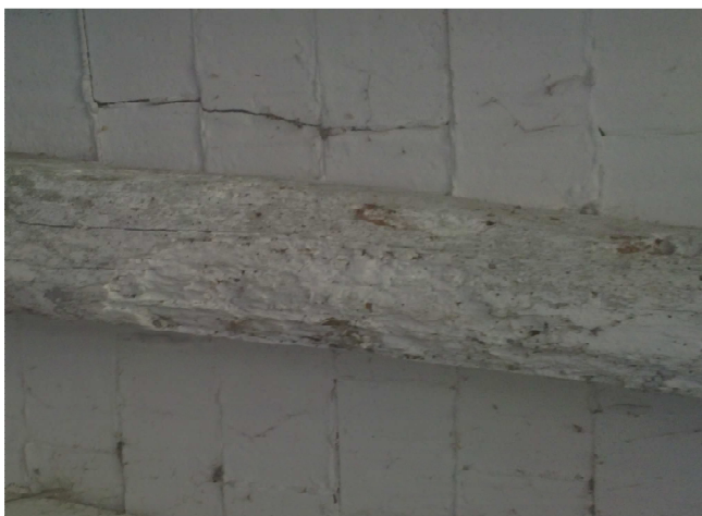
Foto 49: Biga afectada per corc petit, tot i que no sembla tenir pèrdua de secció important.
