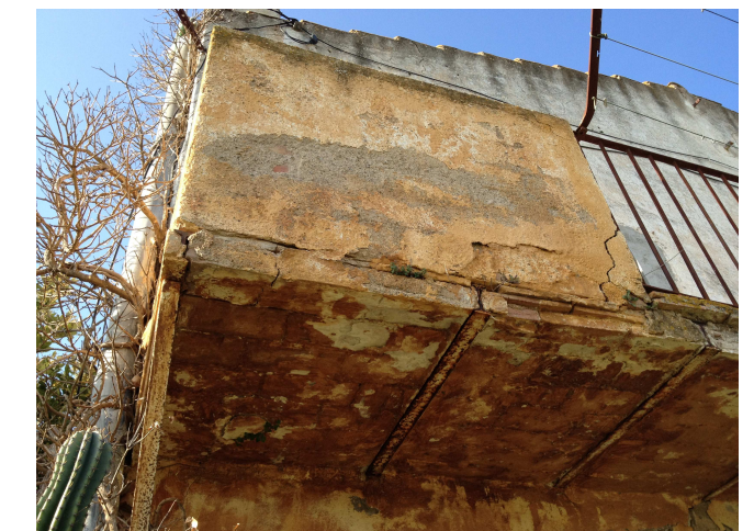
Foto 46: Oxidació de les biguetes que suporten el replà d'escala, en el tercer volum.
