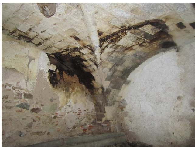
Foto 42: Volta ceràmica afectada per humitats accidentals, causades pel trencament de les instal·lacions
