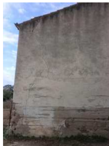
Foto 12: Exterior de la façana Est, on s'hi observa l'esquerda obliqua.
