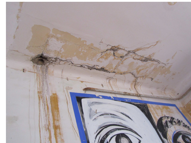
Foto 23: Corrosió dels nervis d'acer que provoca esquerdes en la part inferior del forjat, en la planta pis de l'edifici C.
