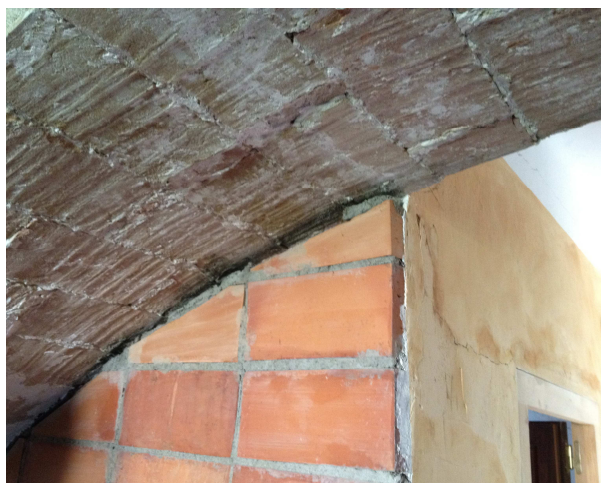
Foto 12: Separació entre l'arc i la paret interior, causada pel descens del forjat.
