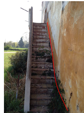
Foto 7: Escales amb vegetació, esquerdes en la unió amb el murs i fissures superficials.
