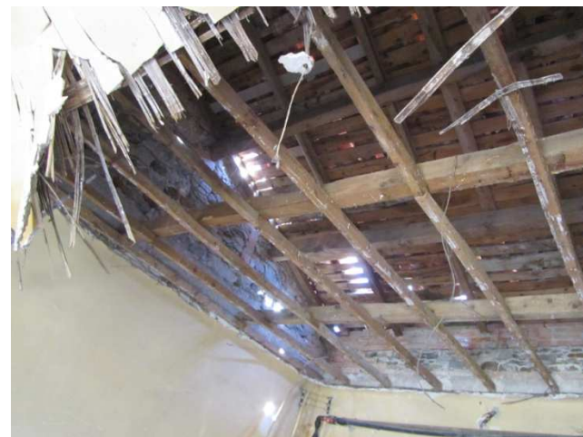
Foto 14: Detall del col·lapse del fals sostre i discontinuitats en la coberta.
