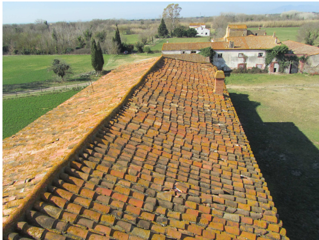
Foto 3: Vista exterior de la coberta, on s'hi observen teules trencades o desplaçades.
