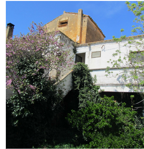
Foto 51: Vegetació invasiva en el pati interior de la masia, que afecta l'escala exterior.
