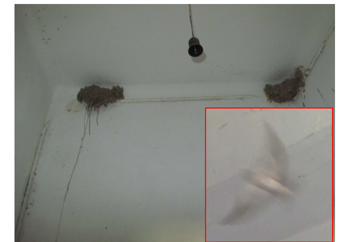
Foto 54: Afectació per nius d'ocells, en el tercer volum de la masia.
