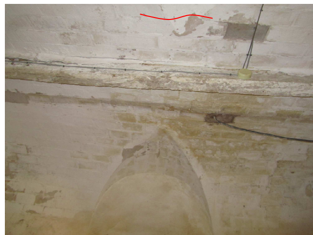
Foto 28: Vista general de la biga desapareguda i de l'esquerda horitzontal.
