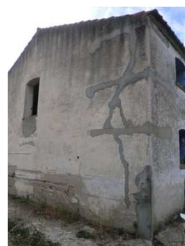
Foto 14: Esquerda reparada en la trobada entre la façana Est i el mur posterior. Font: Grup 1 DAC – Rehabilitació.
