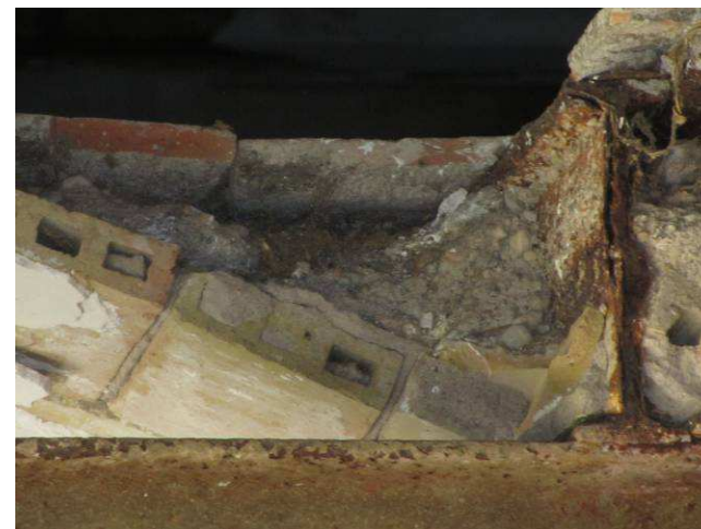
Foto 3: Detall del forjat, on s'observen la bigueta oxidada, la volta ceràmica, el reblert de morter i la rajola.
