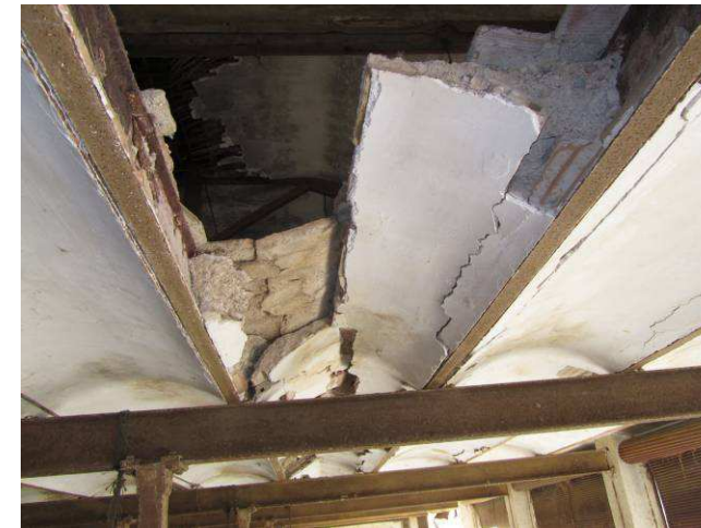
Foto 6: Trencament de la volta ceràmica i col·lapse parcial d'aquesta.
