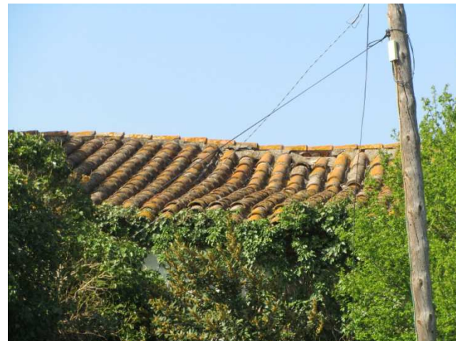
Foto 12: Detall de l'enfonsament parcial de la coberta.
