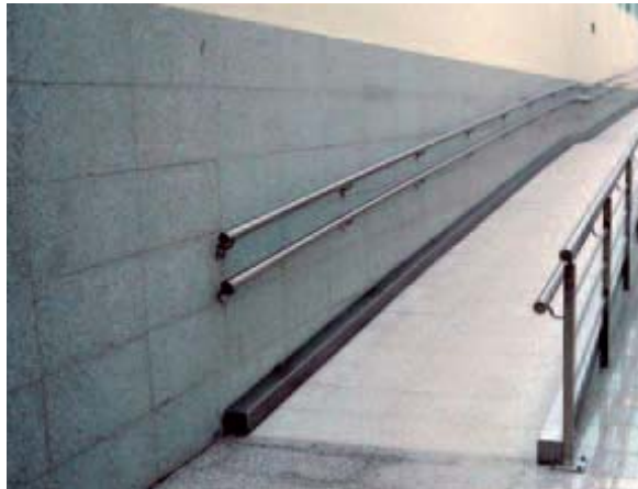
Figura 22. Imagen de ejemplo para ver una correcta colocación de la barandilla y el pasamanos. 39
